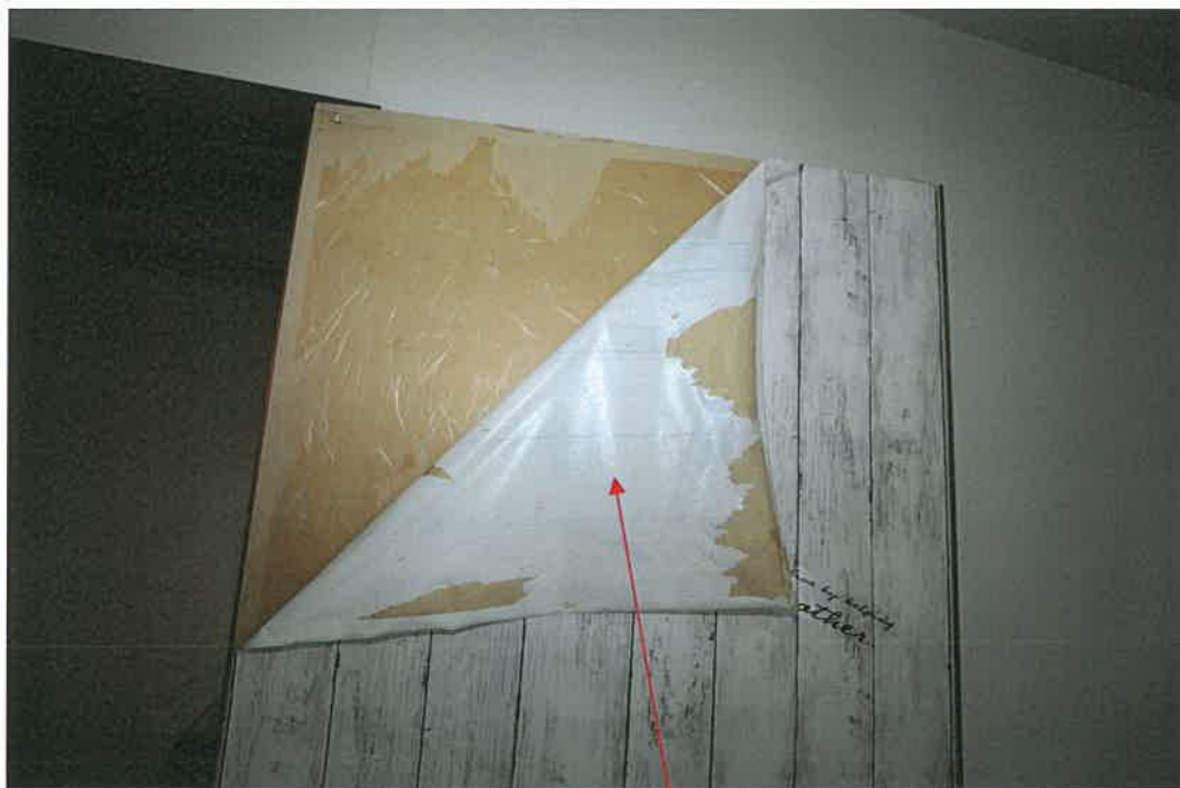
物件 2 建物 1 階室内 クロスの剥がれ
