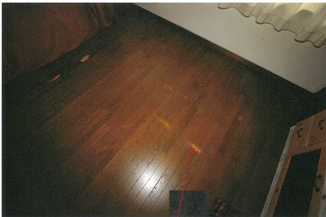
物件 2 建物 1 階室内 フローリングの傷
