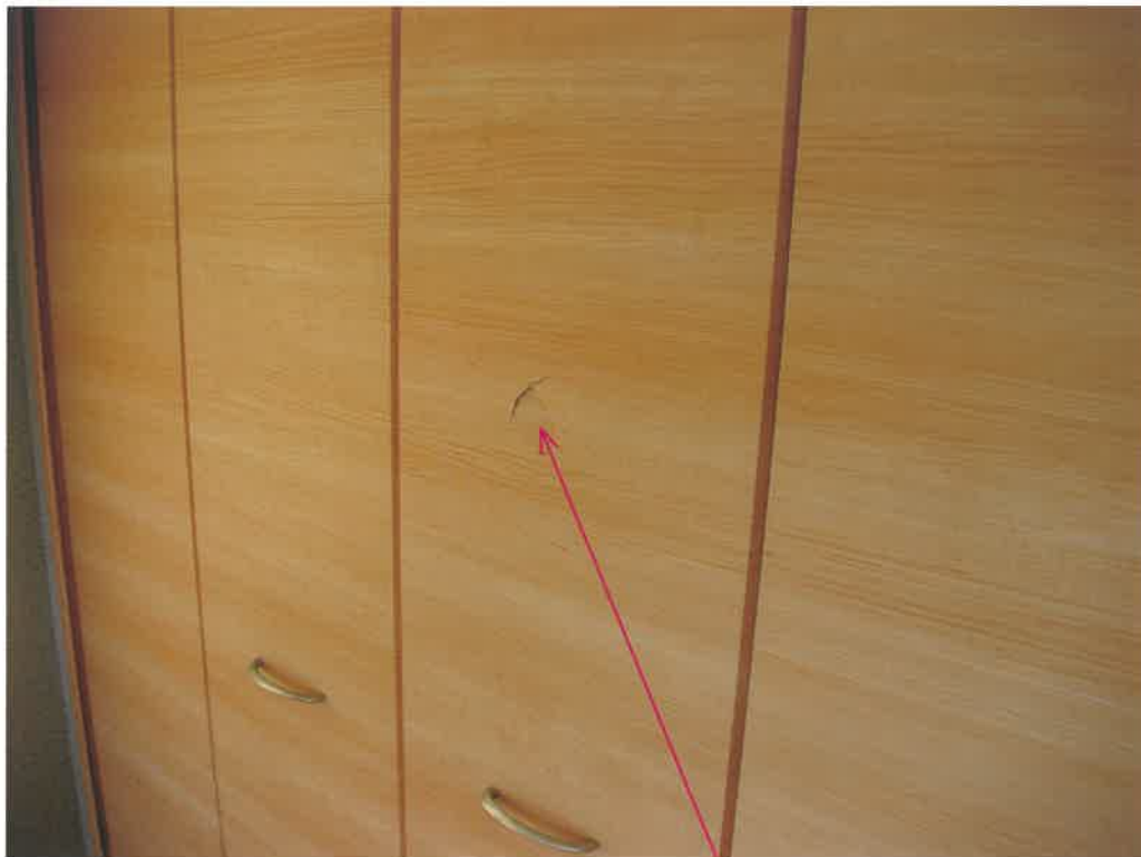
前同建物の2階室内（損傷箇所）
