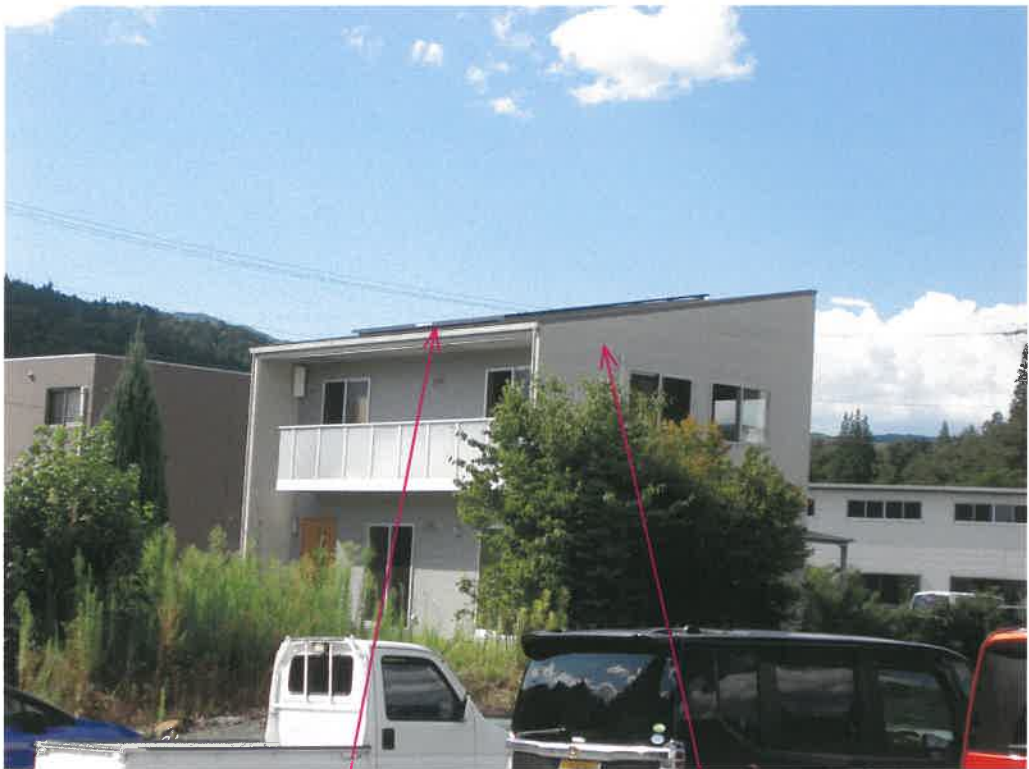
太陽光パネル
