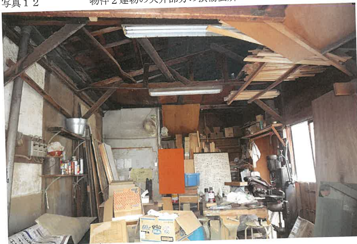
物件 2 建物の天井部分の損傷箇所
