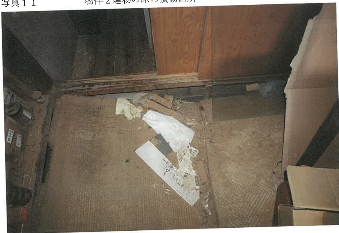
物件 2 建物の床の損傷箇所
