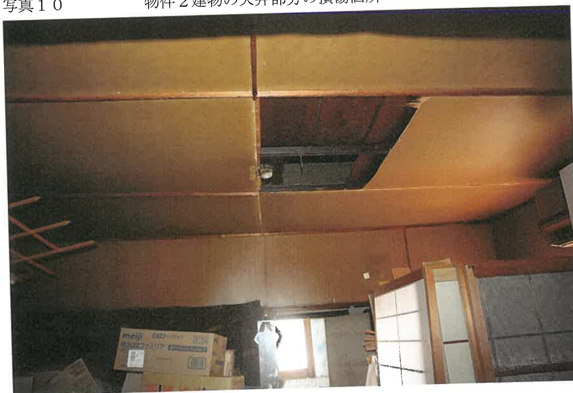
物件 2 建物の天井部分の損傷箇所
