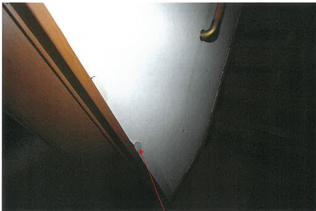
物件 2 建物 1 階室内 クロスの破れや剥がれ
