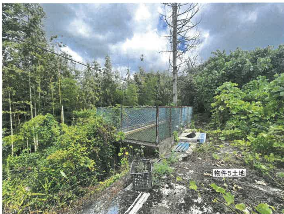
写真④ 物件5土地内の沈殿槽を撮影
