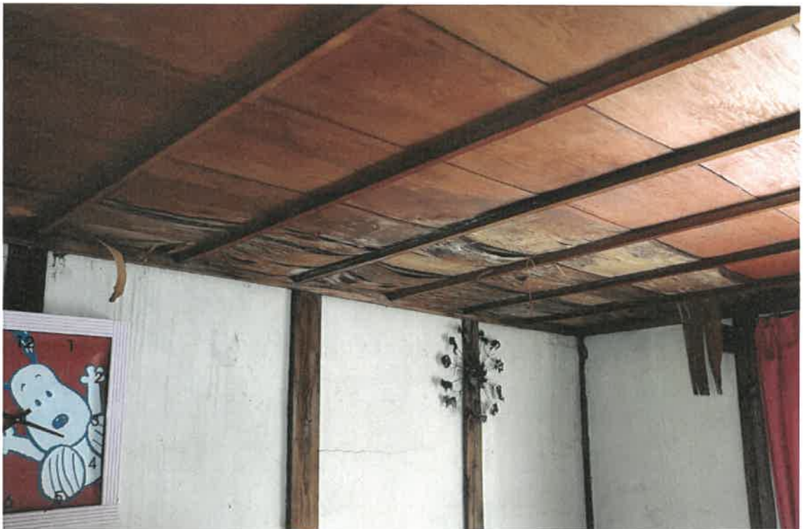
物件 2 建物 2 階北西側和室の天井の損傷箇所
