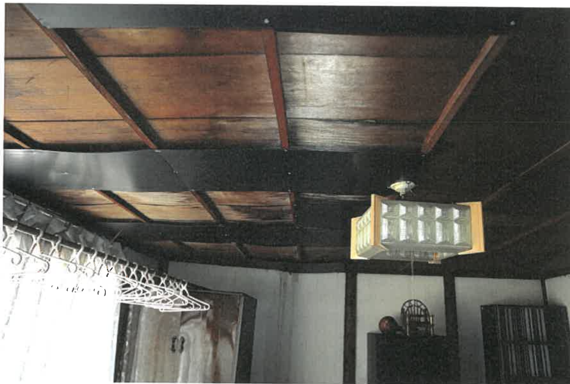
物件 2 建物 2 階南西側和室の天井の損傷箇所
