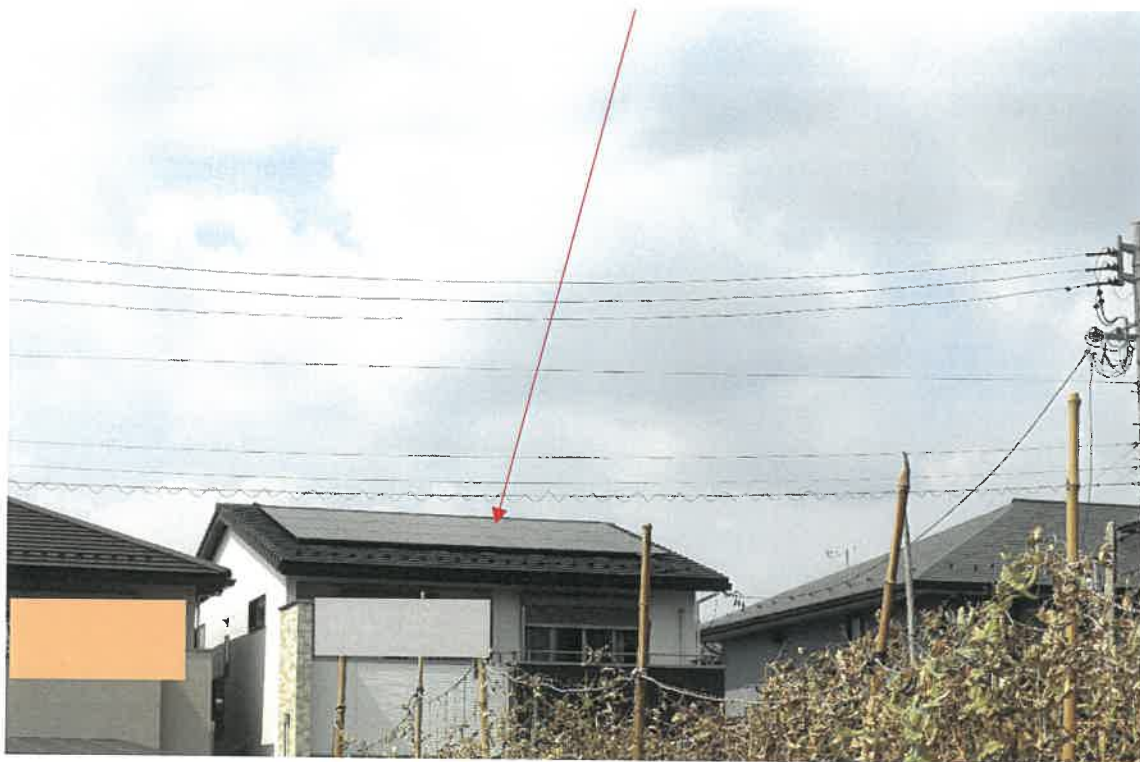
太陽光パネルの設置状況
