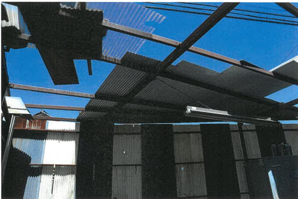
物件 3 附属建物 3 の損傷状況
