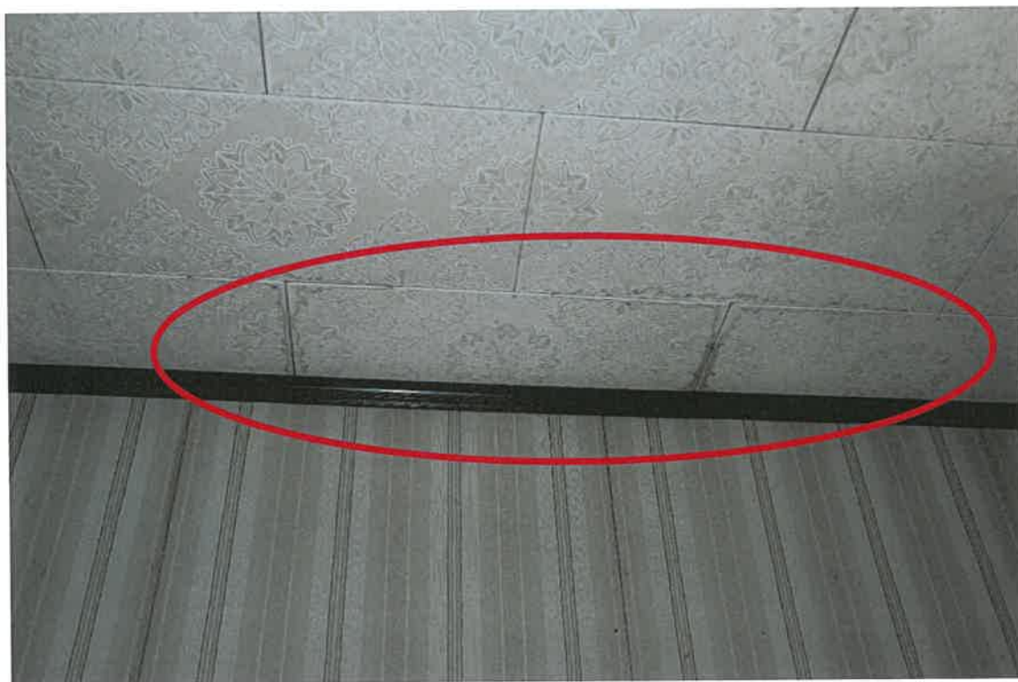
物件 3 主建物 2 階天井部分の損傷箇所
