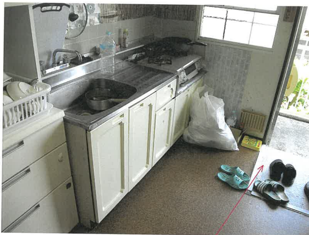
前同建物の203号室内（玄関の床の不安定箇所）
