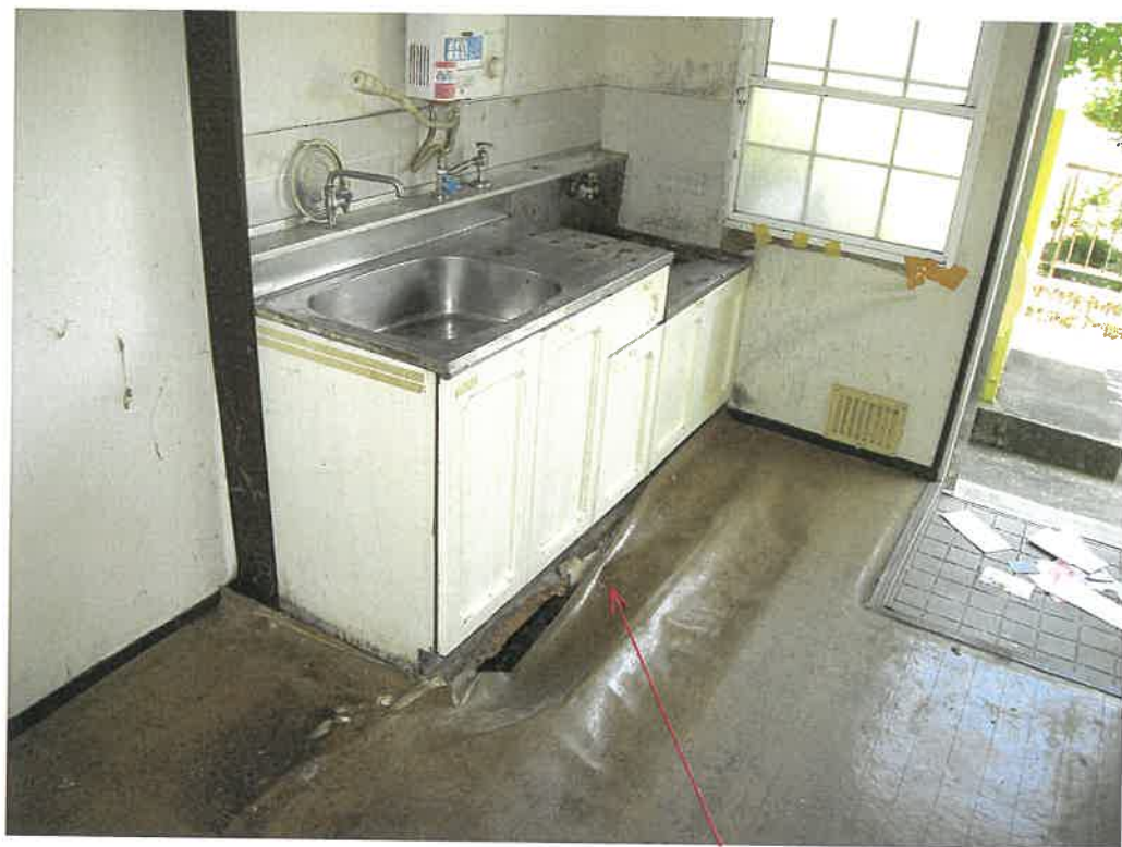
物件3建物の105号室内（床の損傷箇所）
