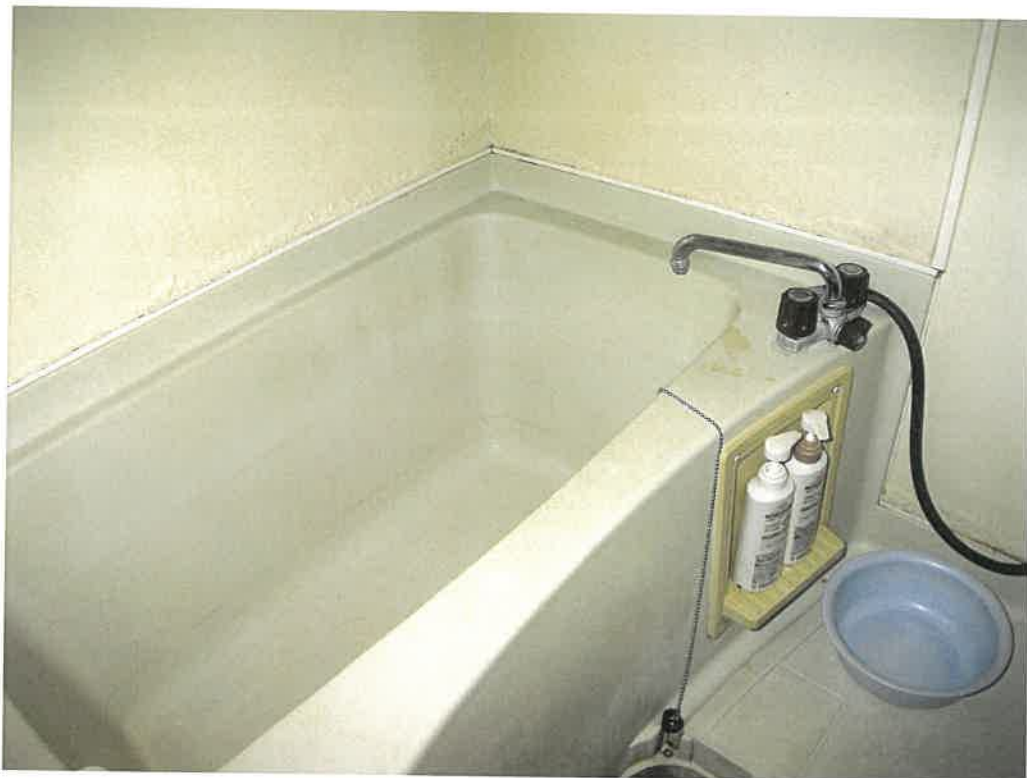
前同建物の101号室内
