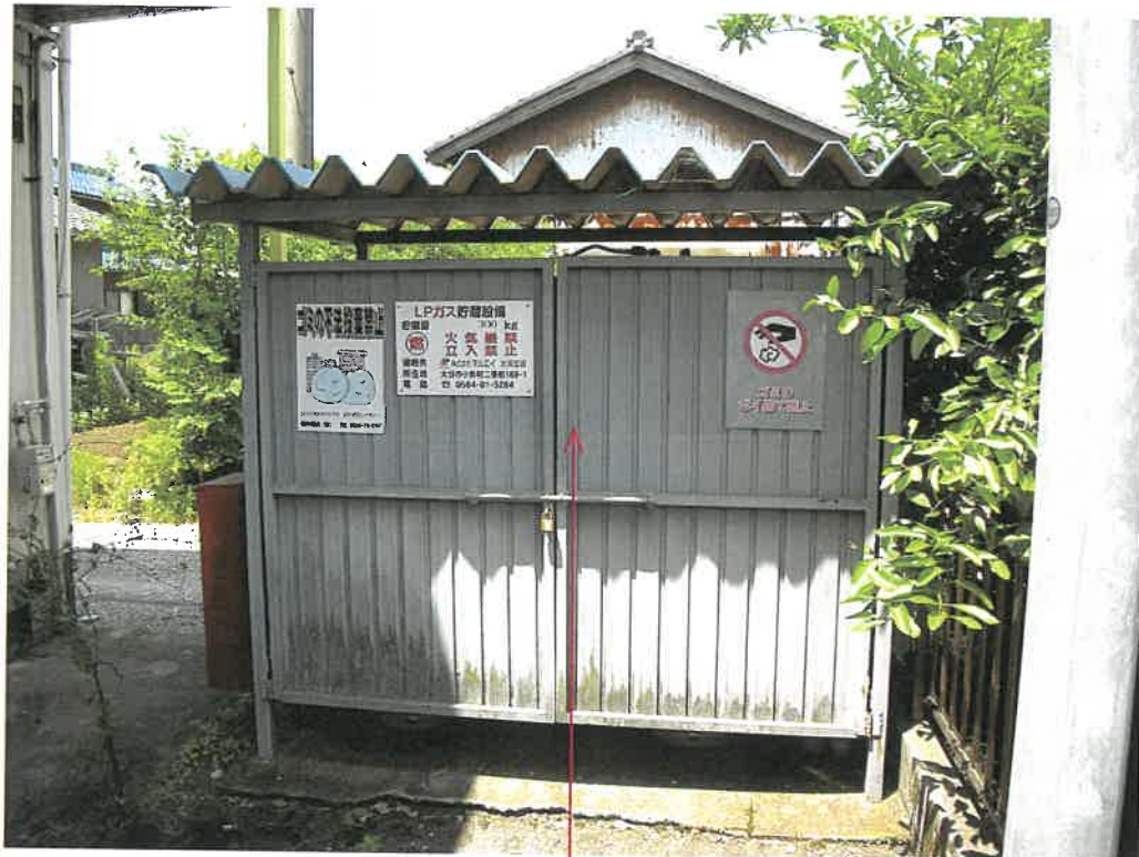
LPガス収納庫
