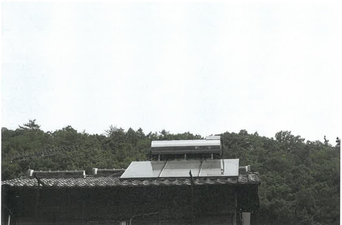
物件 3 建物の屋根に設置されている熱温水器
