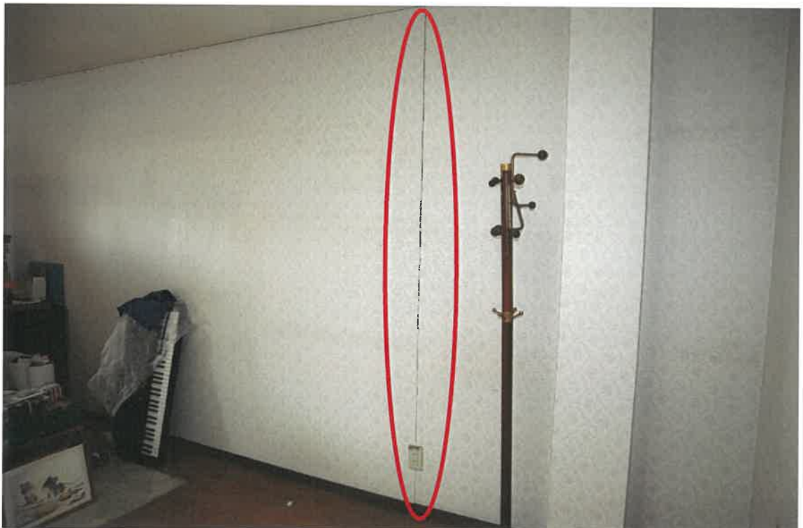
物件 2 建物 3 階東側洋室のクロスの損傷箇所
