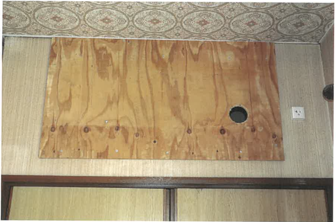
物件 2 建物 3 階西側洋室の壁の損傷箇所
