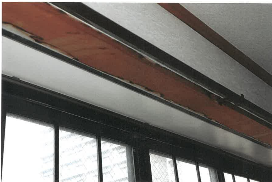
物件 2 建物 2 階西側和室の柱のシミ
