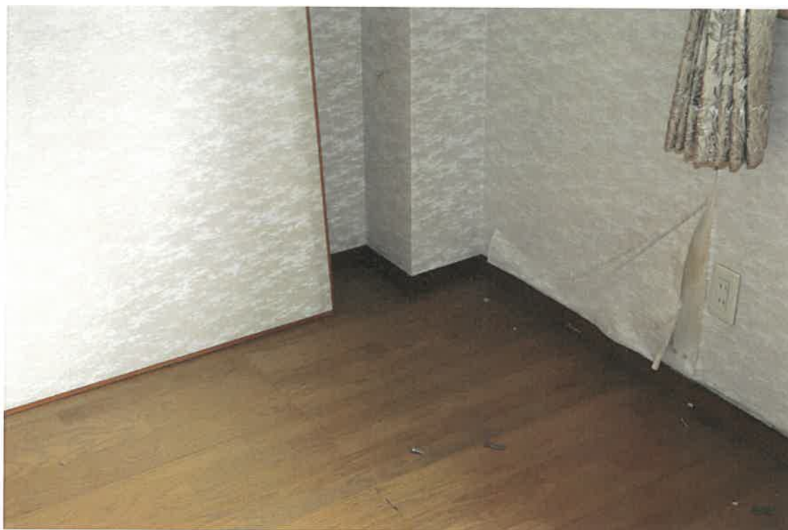
物件 2 建物 2 階西側和室の壁の損傷箇所
