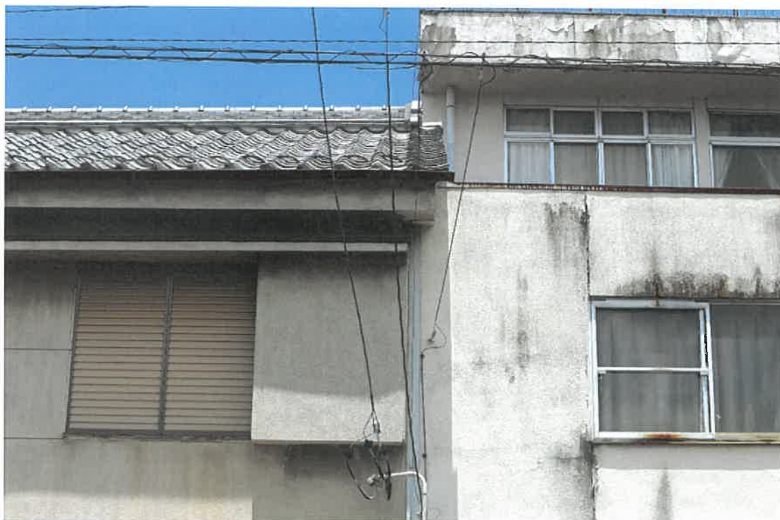
写真16 物件2建物の屋根の一部が物件1土地の東側隣地（地番10番）上に越境しているものと思料する状況
