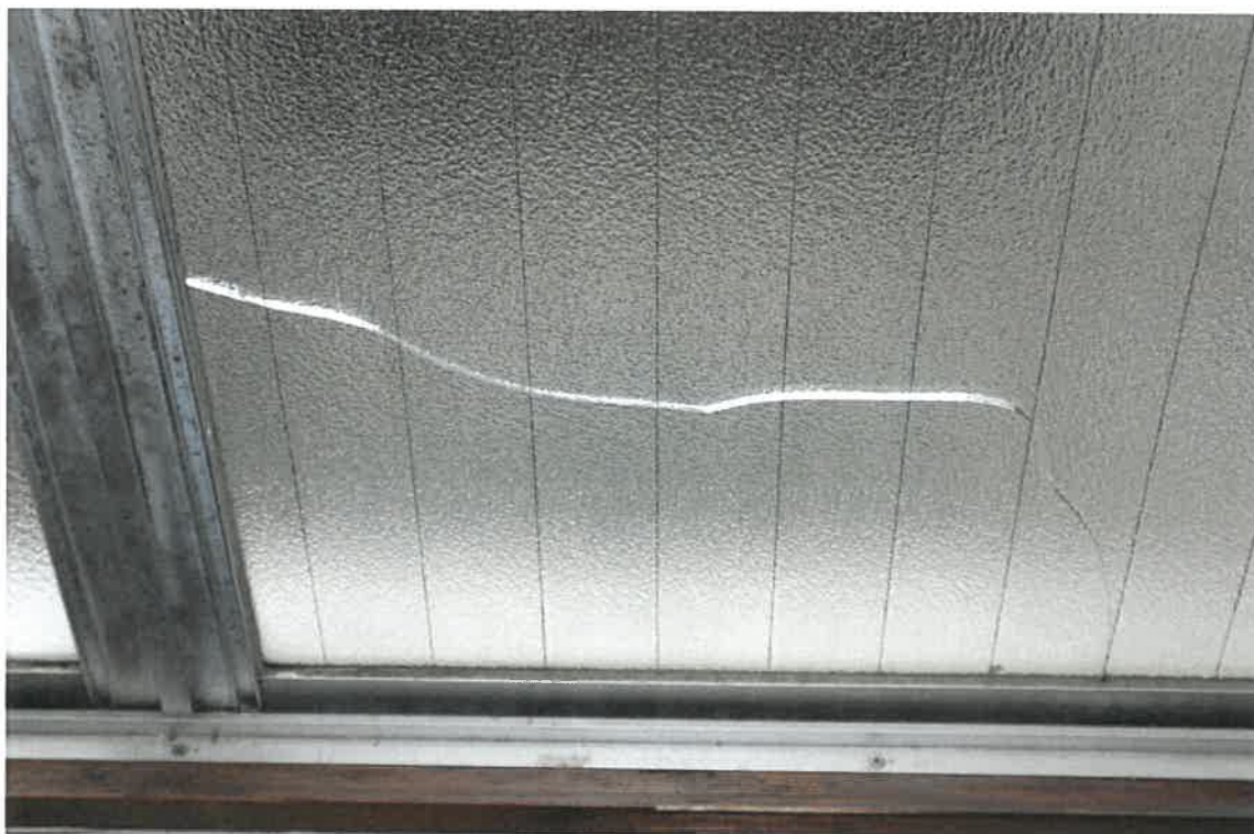
5 0 2 号室内の窓ガラス割れている状況
