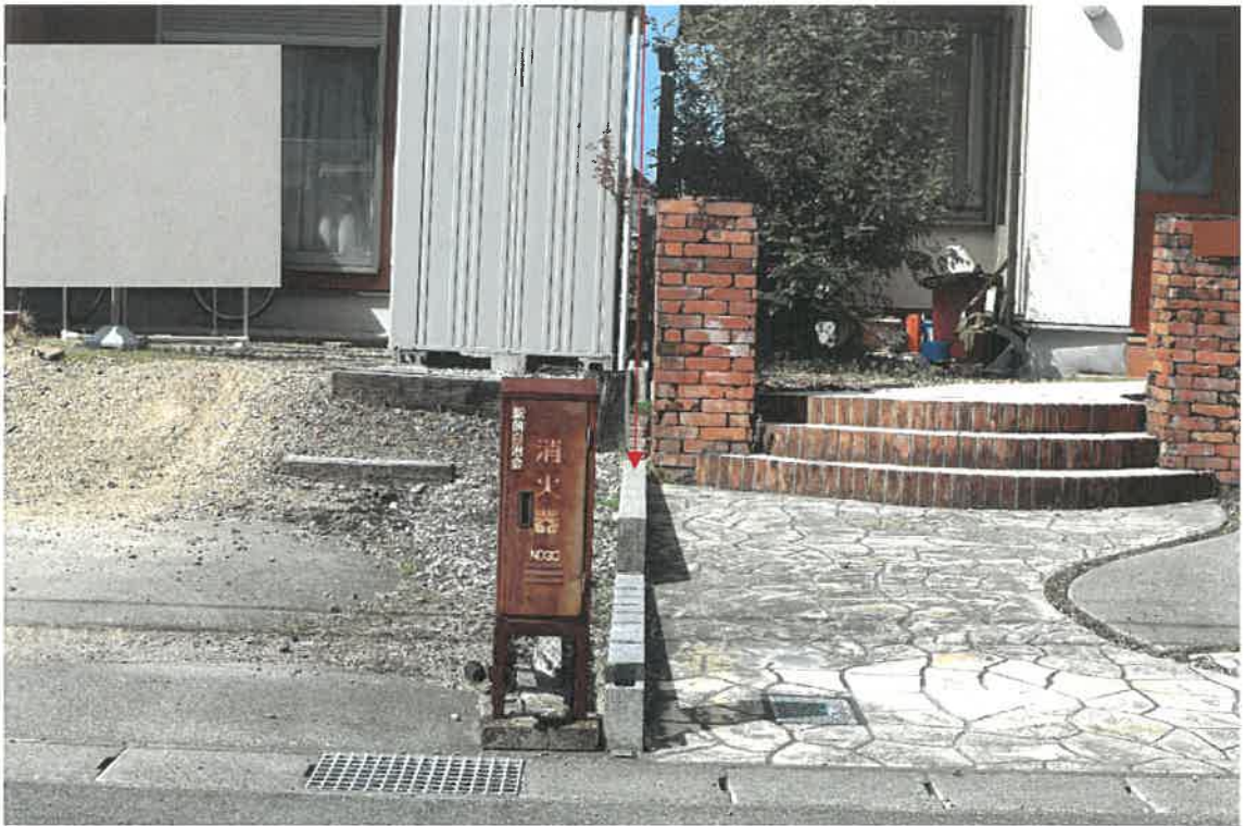
写真1 1 物件1土地と同土地の東側隣地（地番2078番5）の境界線上のコンクリートブロックとフェンスの状況
