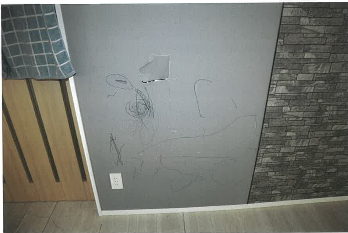
物件2建物1階LDK壁の損傷状況
