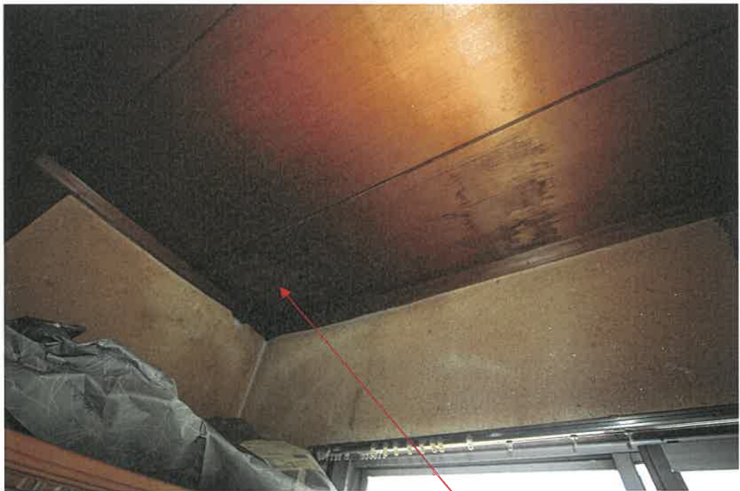
物件 5 主建物 3 階室内 雨漏り痕
