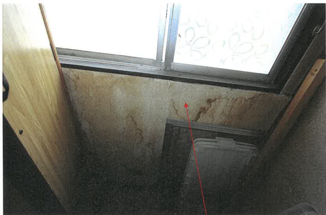
物件 5 主建物 3 階室内 雨漏り痕
