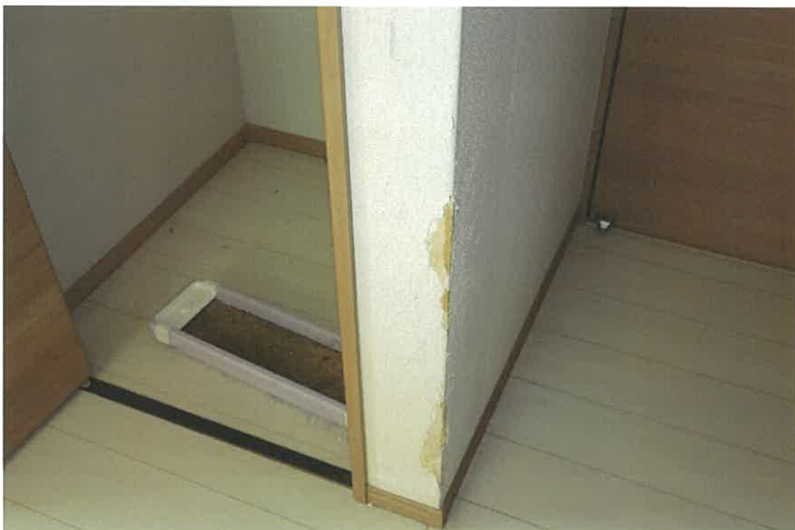
物件 2 建物 2 階南西側洋室の壁の損傷状況
