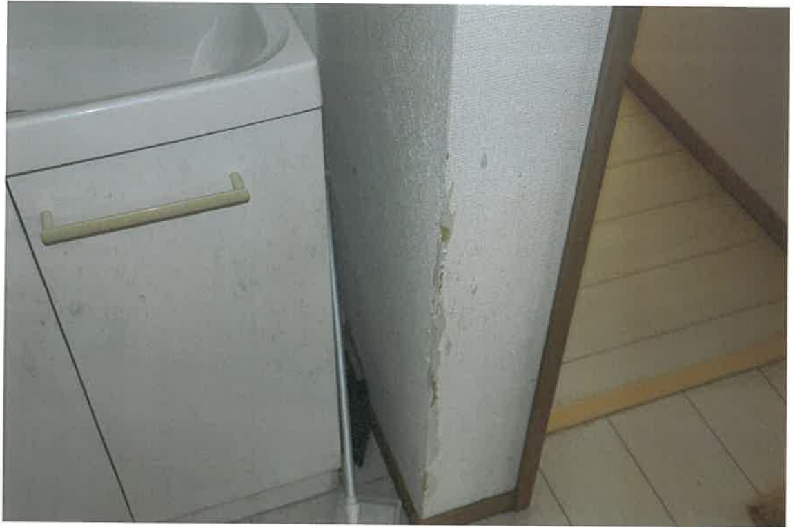
物件2建物2階廊下の壁の損傷状況
