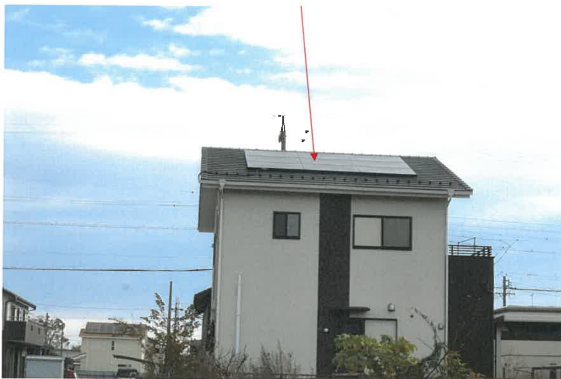
太陽光パネルの設置状況
