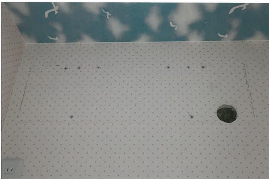
物件 2 建物 2 階南東側洋室の壁の損傷箇所
