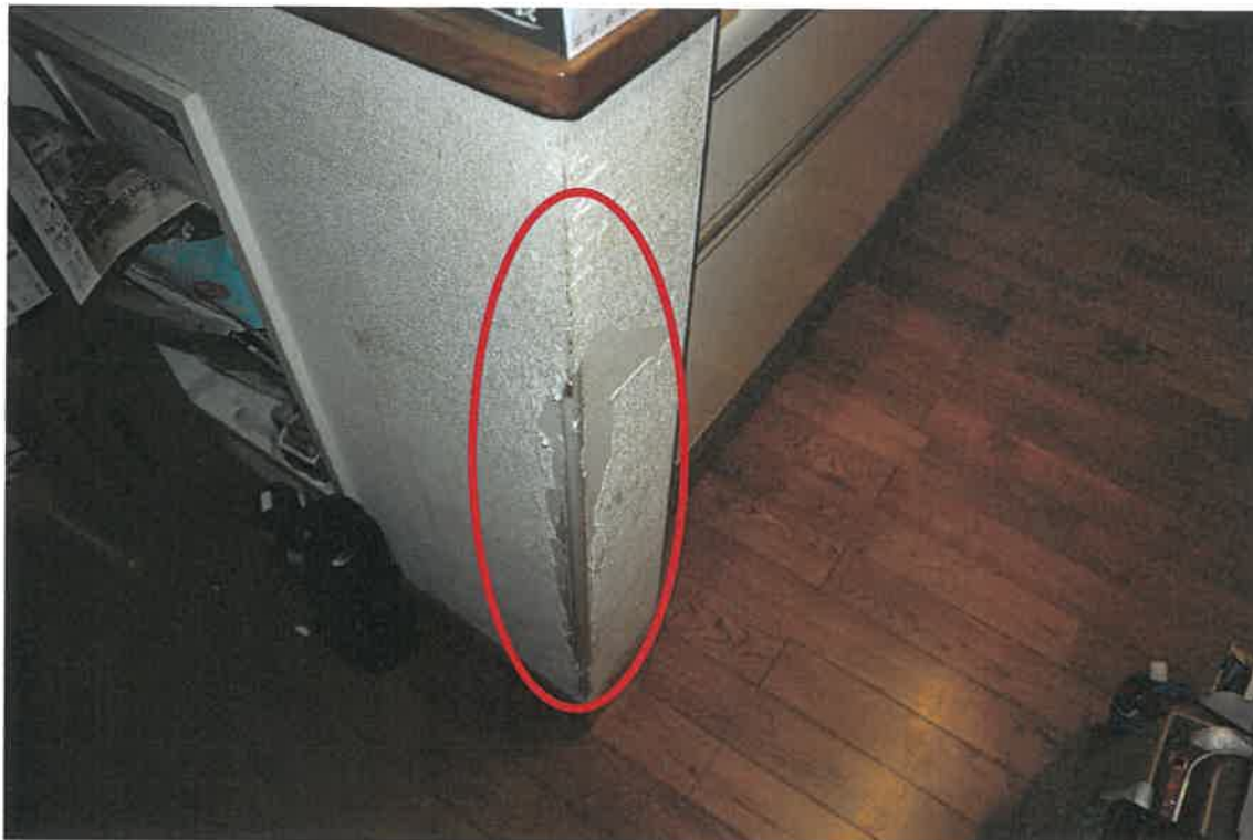
物件 2 建物 1 階 L D K の壁の損傷状況
