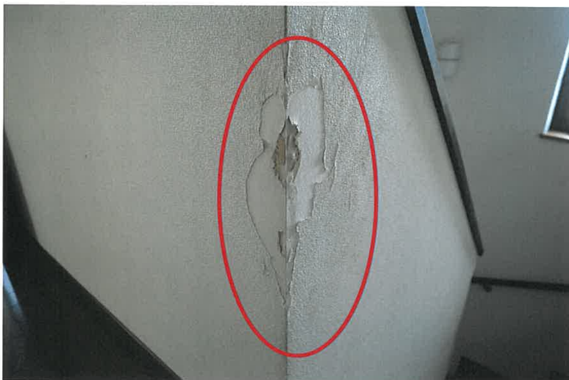
物件 2 建物 2 階階段壁の損傷状況
