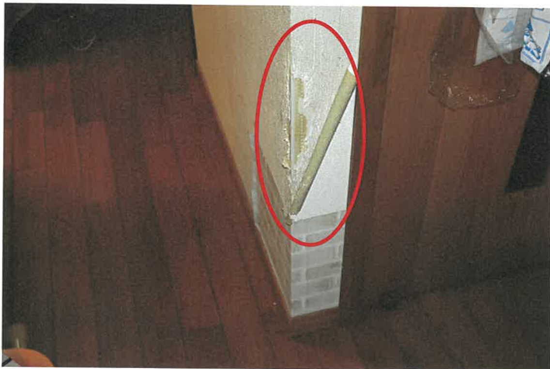
物件 2 建物 1 階 LDK の壁の損傷状況
