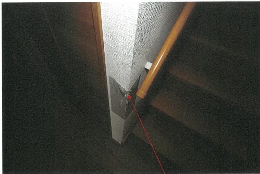
物件 2 建物 1 階室内 引っ掻き傷
