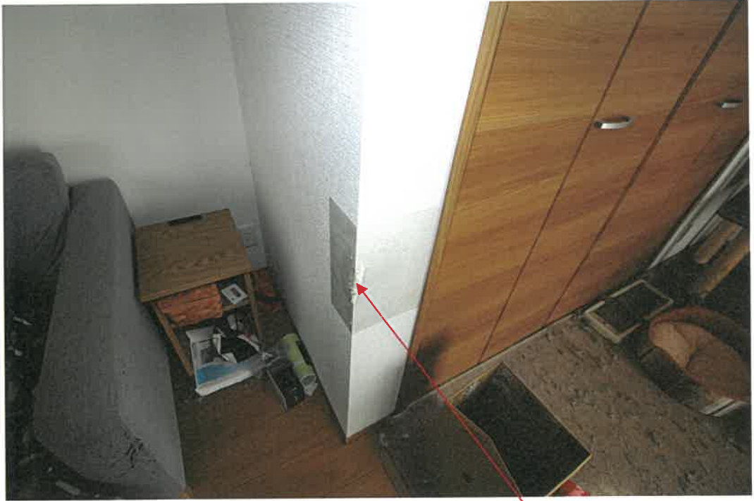
物件 2 建物 1 階室内 引っ掻き傷
