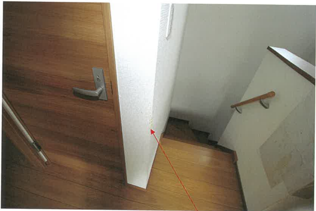
物件 2 建物 2 階室内 引っ掻き傷
