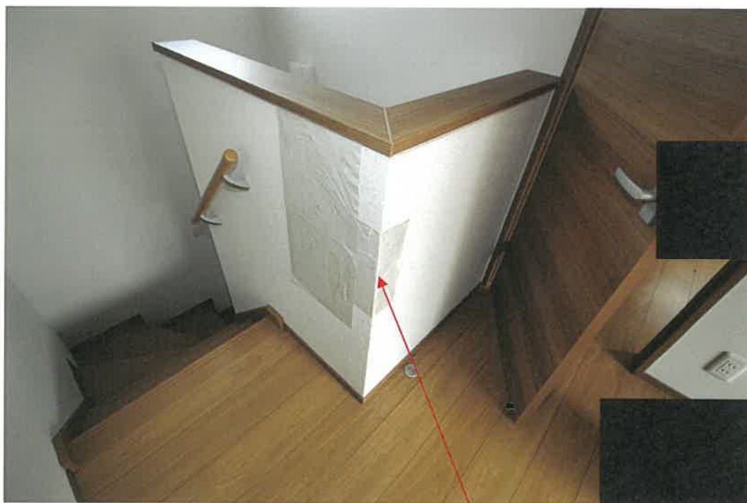
物件 2 建物 2 階室内 引っ掻き傷
