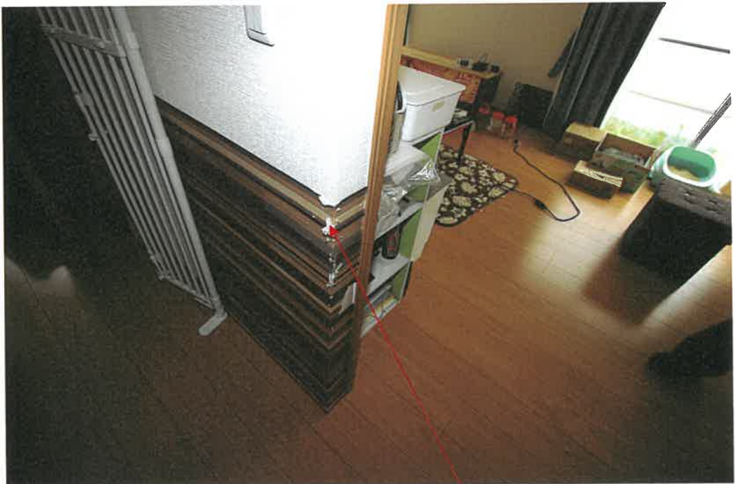
物件 2 建物 1 階室内 引っ掻き傷
