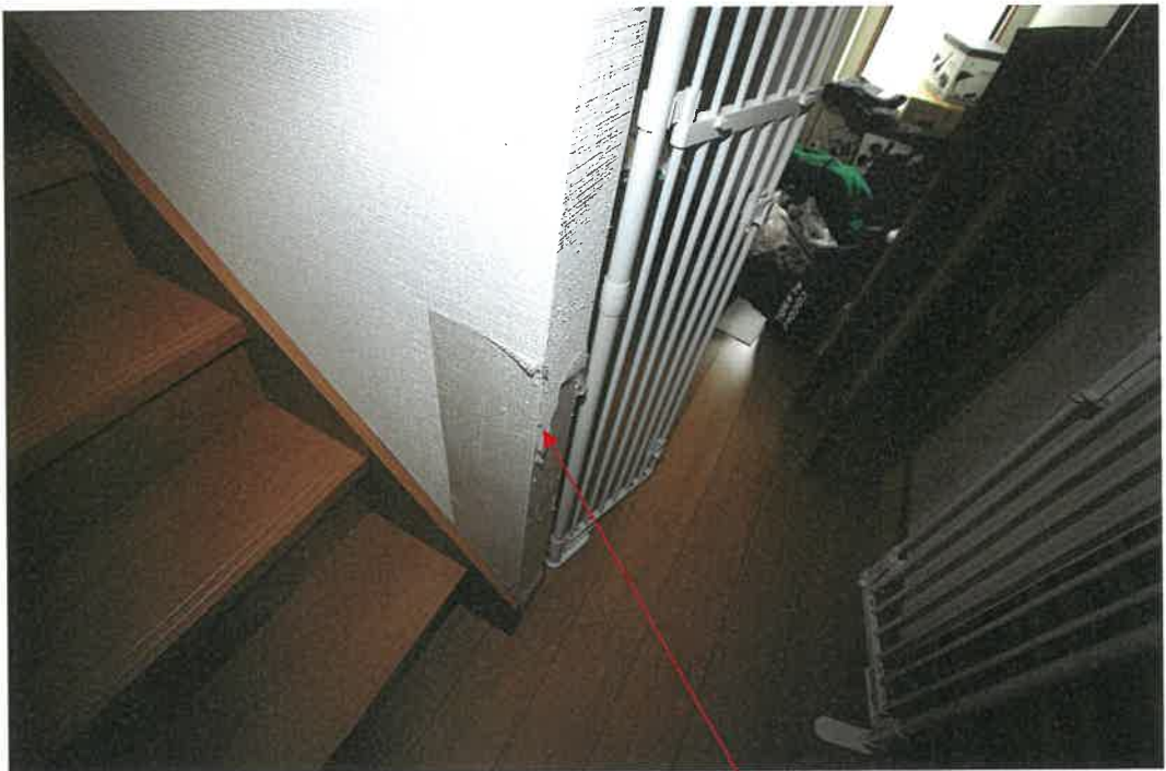
物件 2 建物 1 階室内 引っ掻き傷
