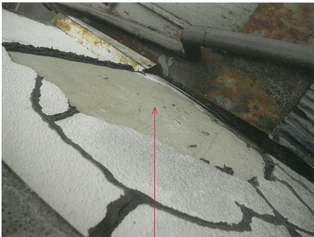
物件1 2 建物の西側外壁の剥落箇所
