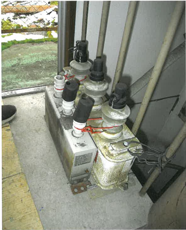
前同建物の螺旋階段最上階踊り場の高圧変圧器及びコンデンサー
