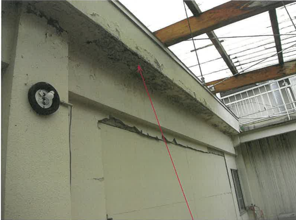
前同建物の2階テラス内（外壁剥落箇所）
