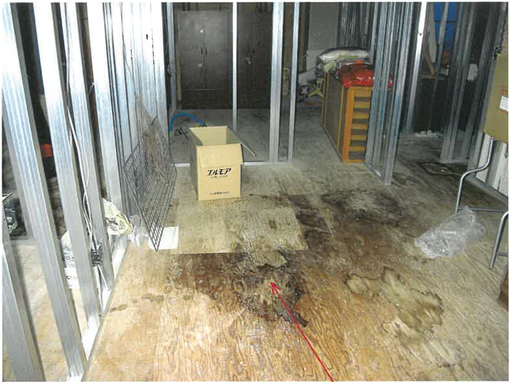
前同建物の2階南側室内（雨漏りによる染み）
