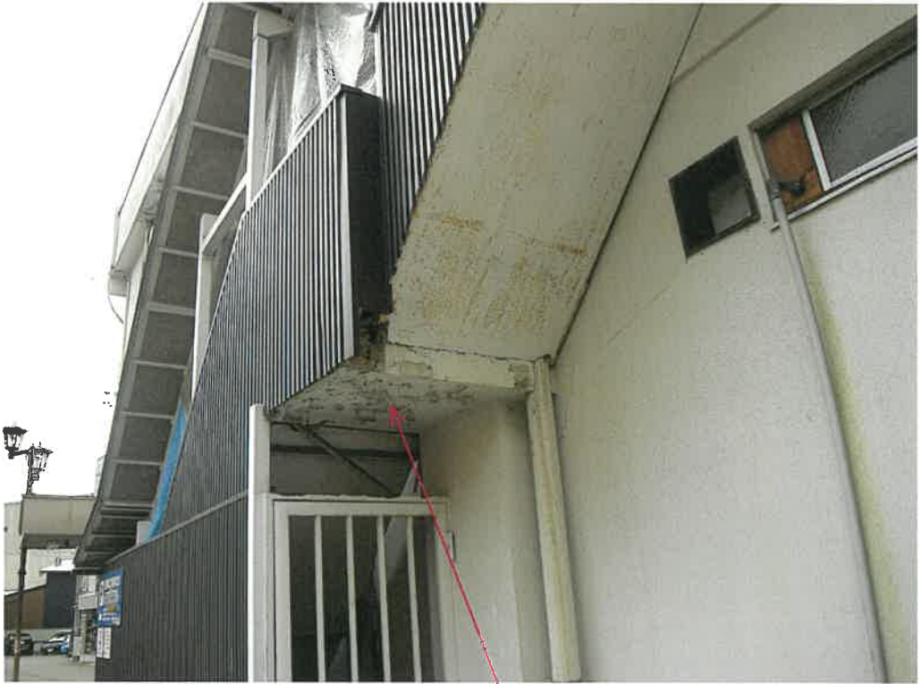
物件1 2建物の2階への東側外階段の老朽化による損傷箇所
