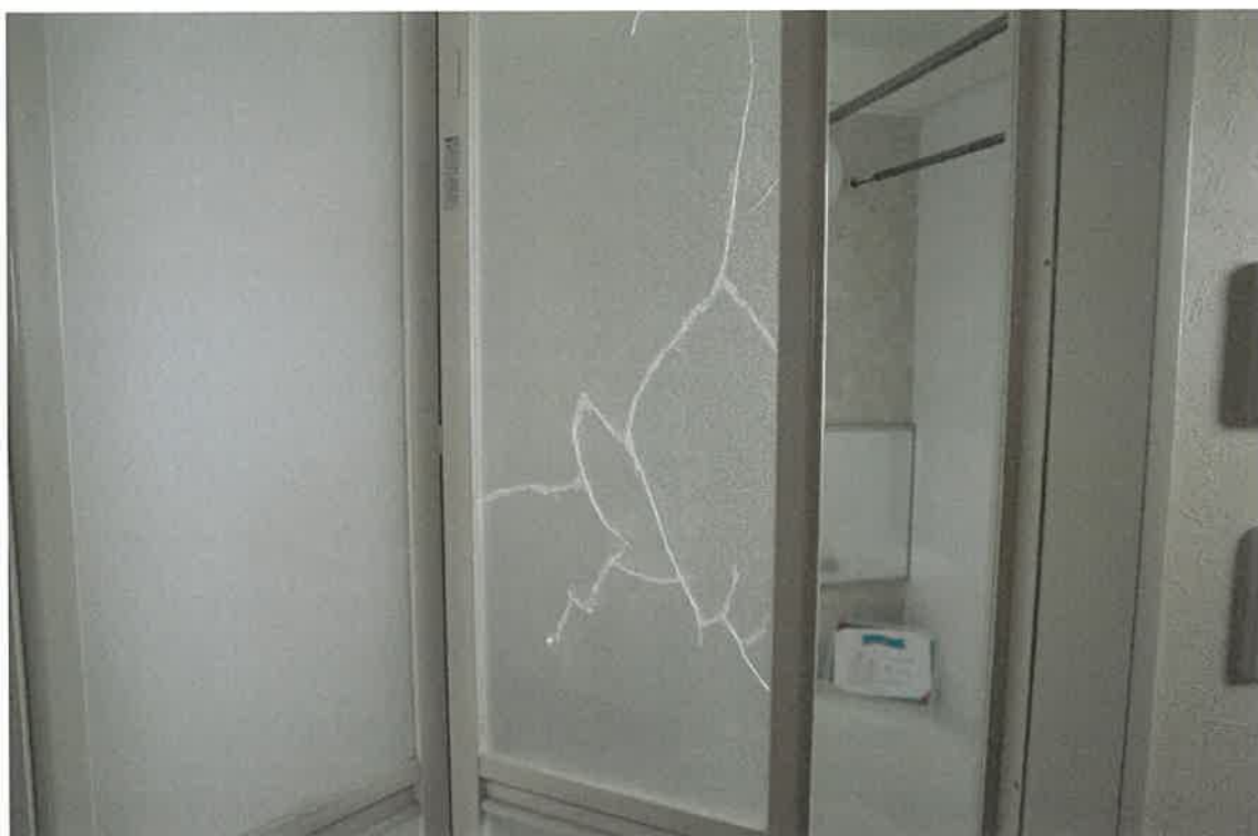
浴室扉の損傷状況
