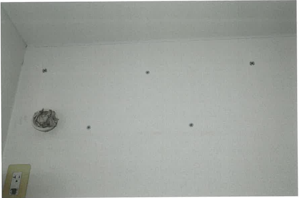
写真1 1 物件2建物2階北東側洋室内のエアコンを取り外した跡
