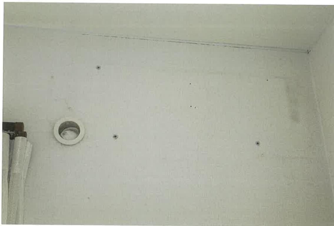
写真13 物件2建物2階南西側洋室内のエアコンを取り外した跡
