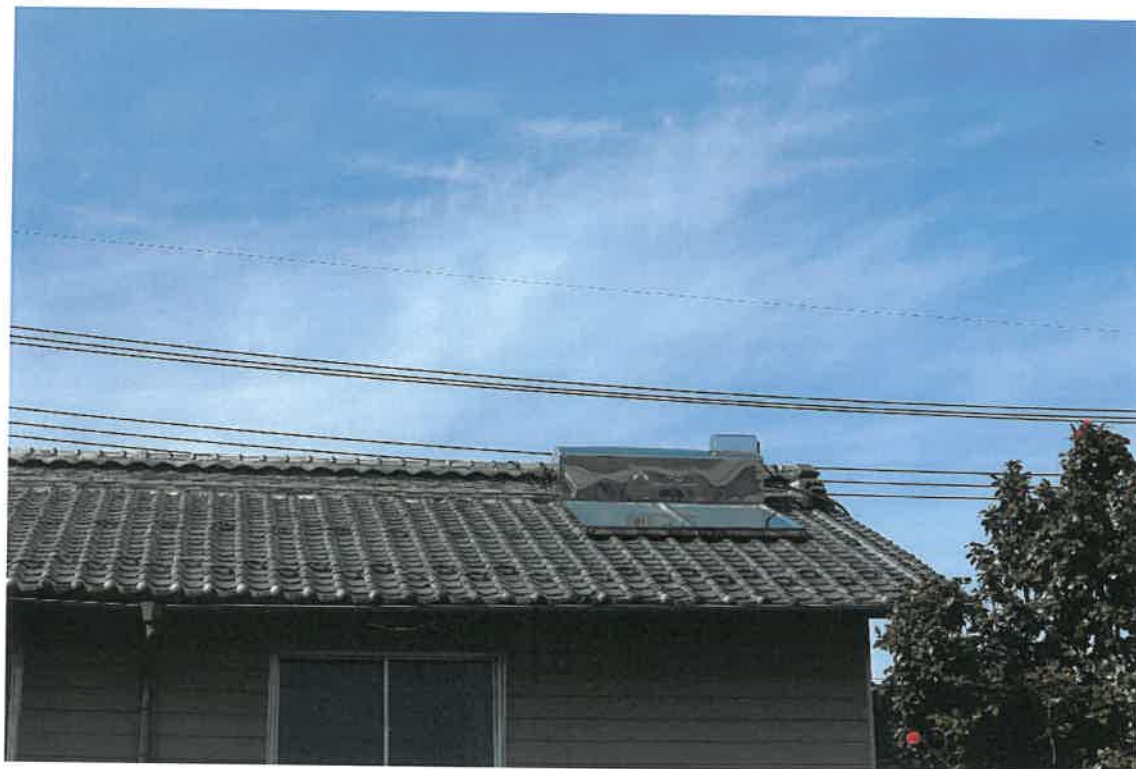
朝日ソーラーの設置状況
