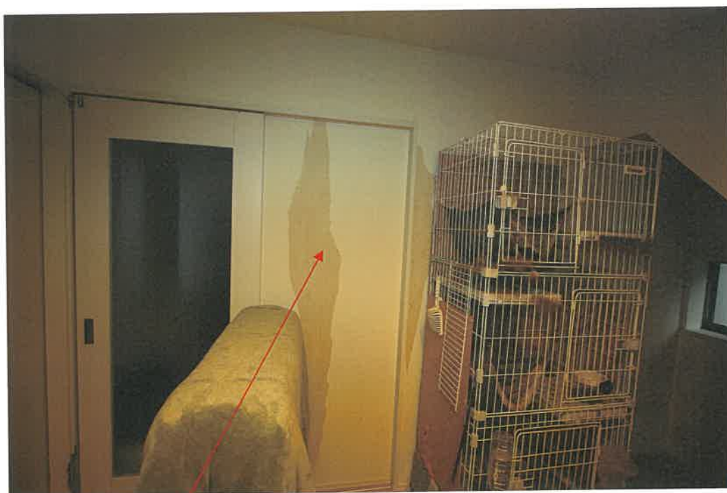
クロスの剥がれ 物件 2 建物 1 階室内
