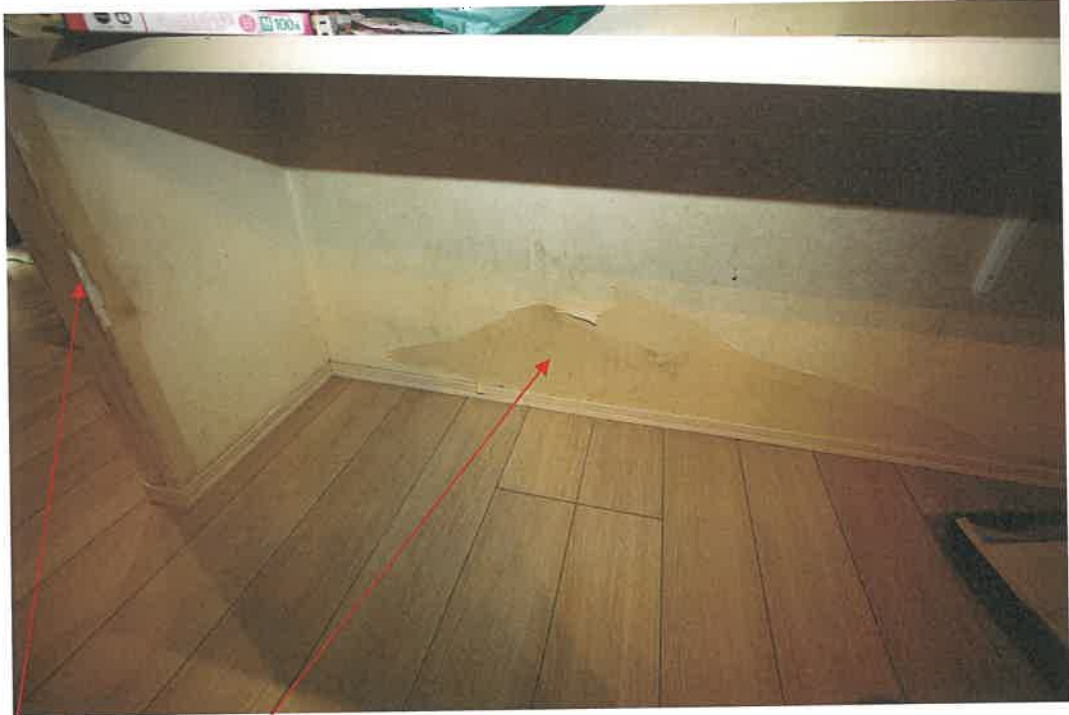
引っ掻き傷 クロスの剥がれ 物件 2 建物 1 階室内
