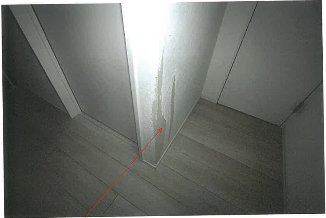
クロスの剥がれ 物件 2 建物 2 階室内
