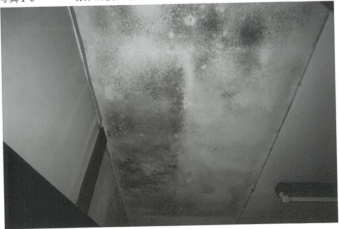
物件 2 建物 1 階洗濯室の天井部分の損傷箇所
