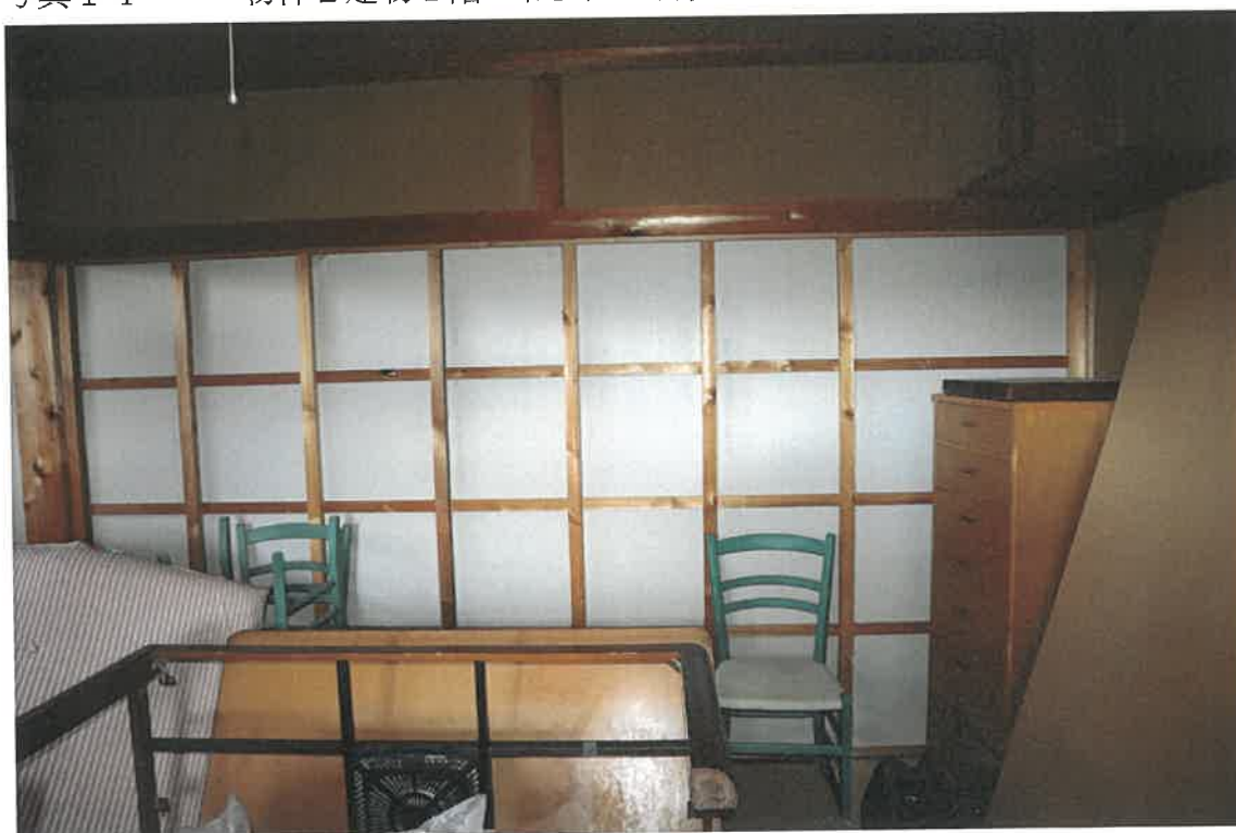
写真1 4 物件2建物1階の和室入口部分を封鎖している状況
