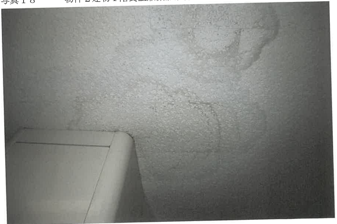
物件2建物1階食堂兼機能訓練室の天井部分の損傷箇所
