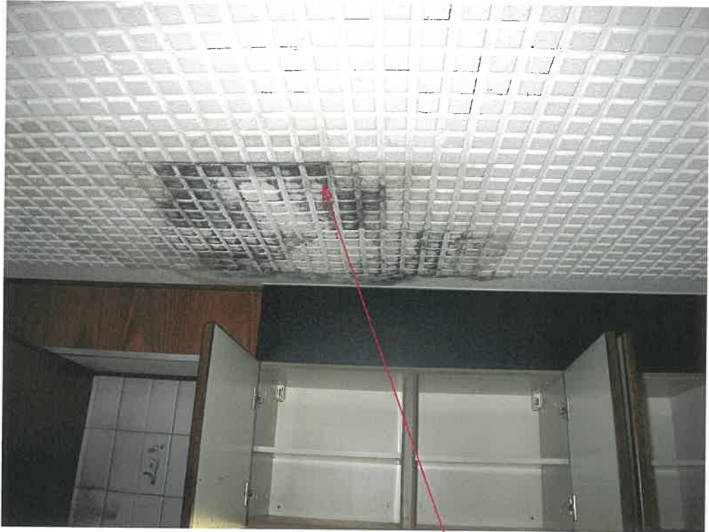
前同建物の1階室内（天井の染み）
