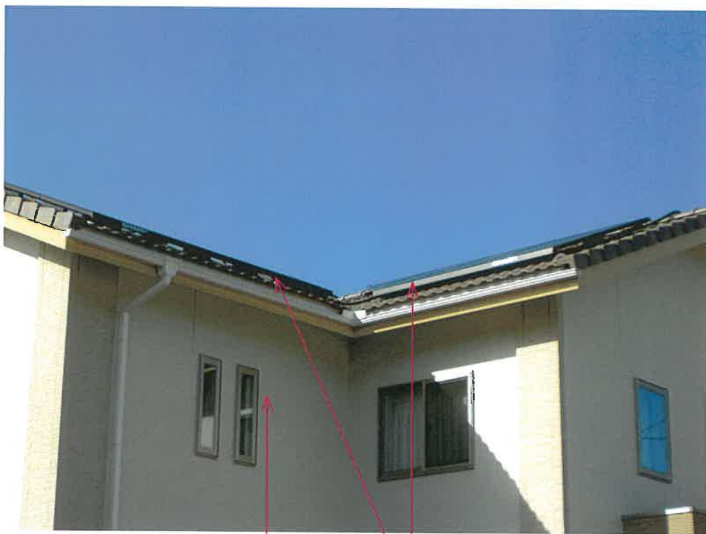
物件 3 建物 (太陽光パネル)
