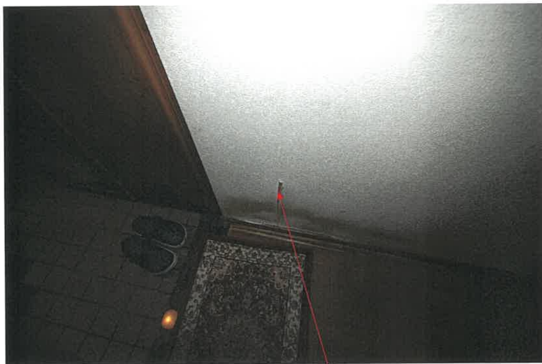
専有部分の建物 室内 クロスの剥がれ
