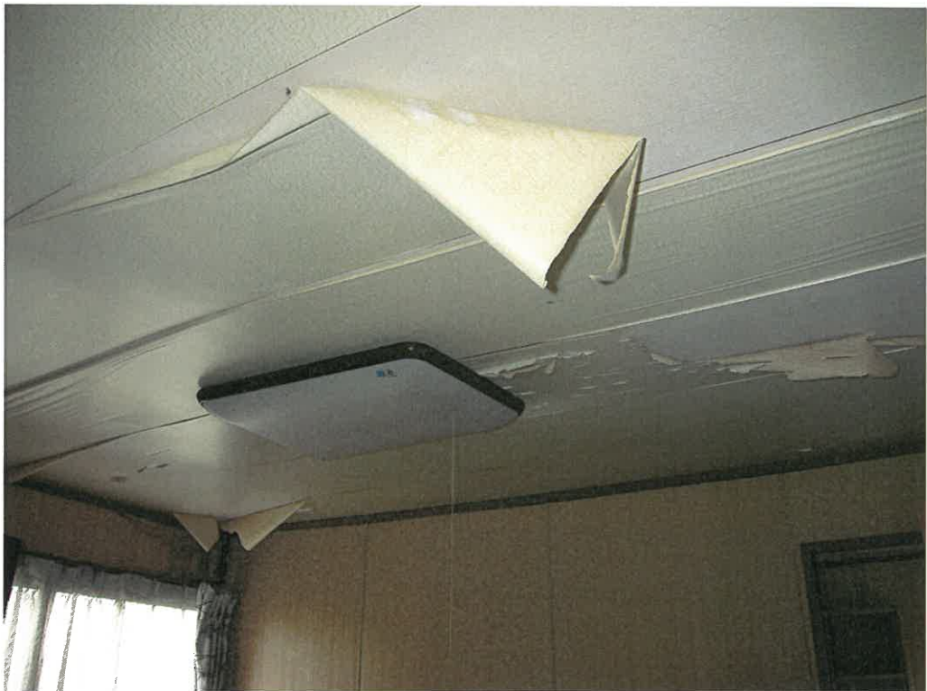
前同建物の室内（天井クロスの剥がれ箇所）
