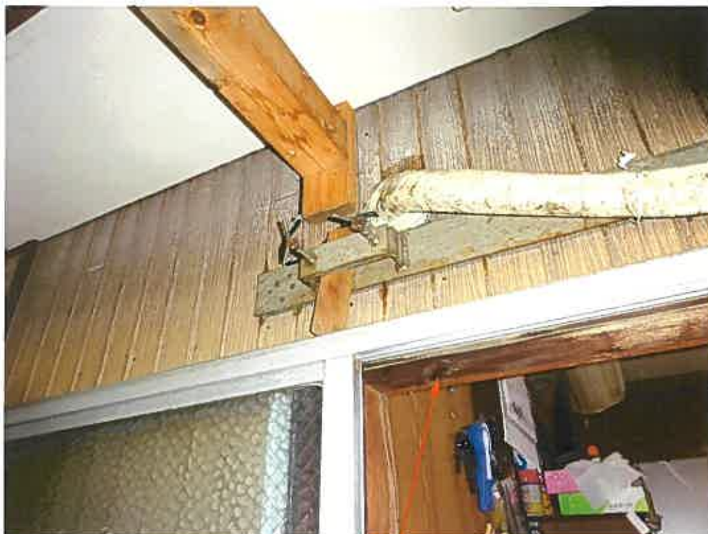
雨漏りのシミ
