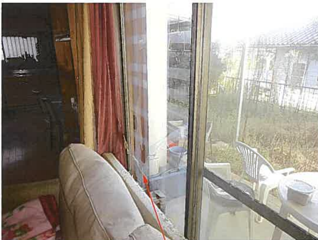
窓ガラスの破損箇所（テープで補修された痕跡）
