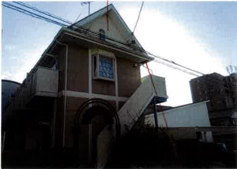
2階外廊下の天井の天板が崩落して外れている状況
