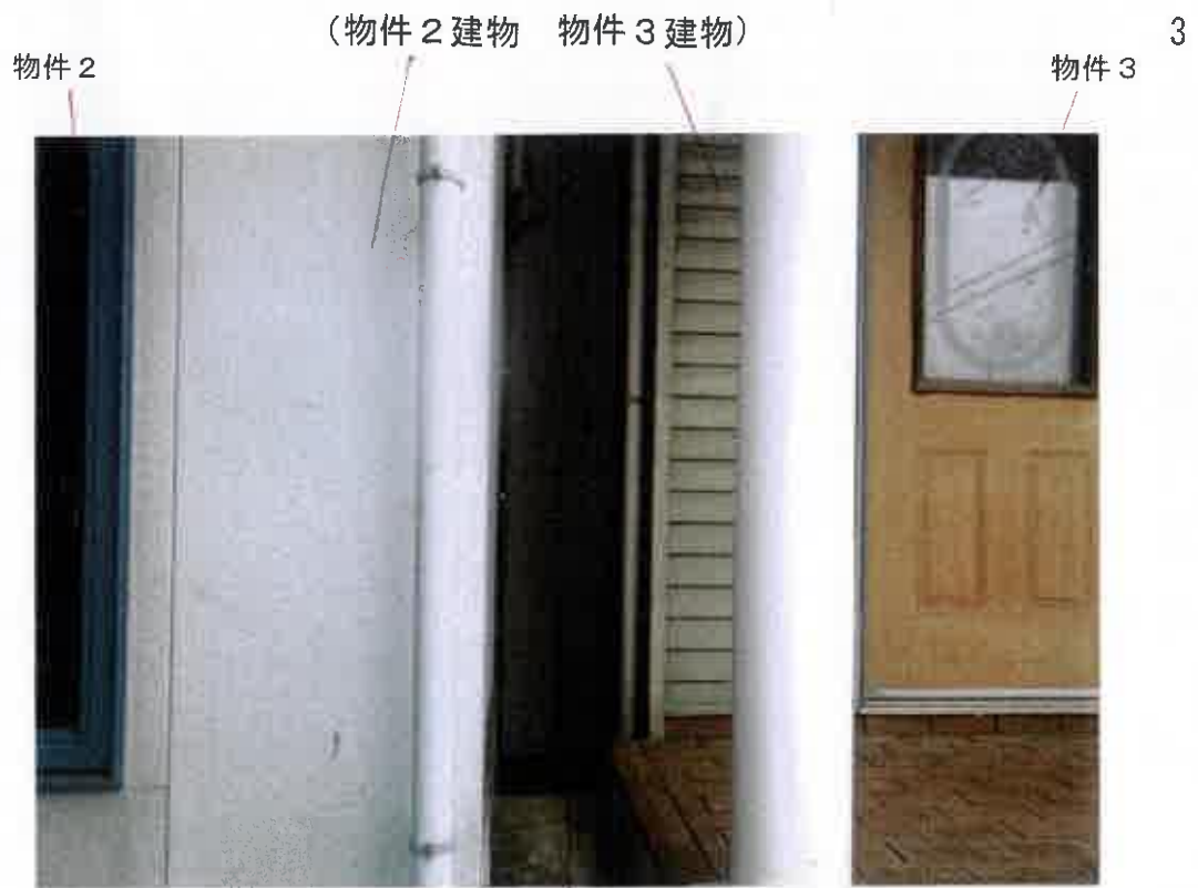
未登記増築部分 (物件 2 建物及び物件 3 建物の屋内の通路) 屋外の状況 (未登記増築部分)
