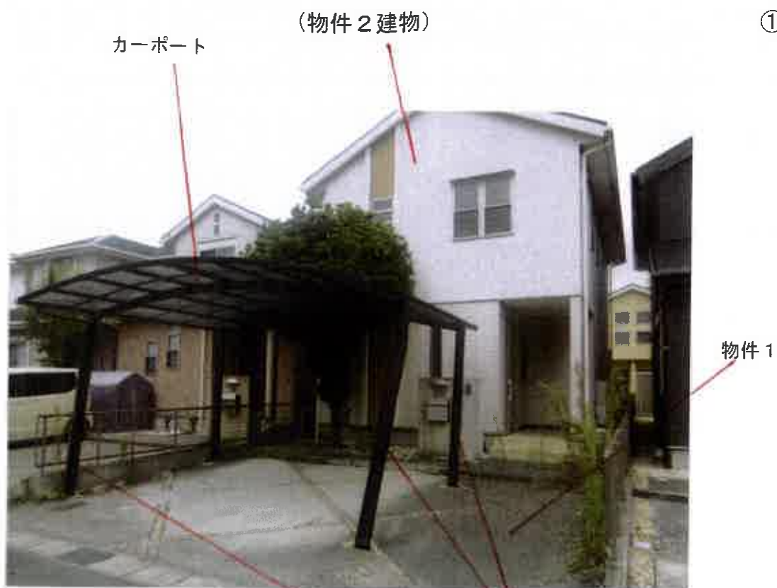
カーポートの支柱が損傷により傾いている状況 屋外の状況
