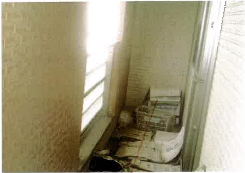
鳩の巣（段ボールの内部が鳩の巣となっている） 屋外の状況（2階 ベランダ1）
