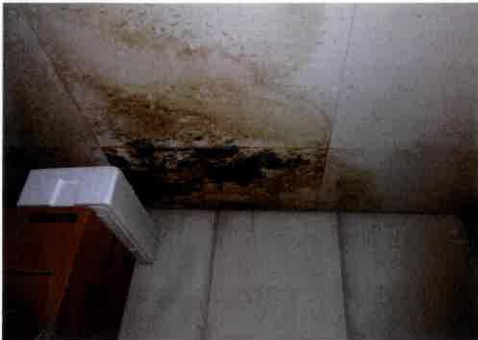
⑪屋内の状況 倉庫1の天井 の状況
