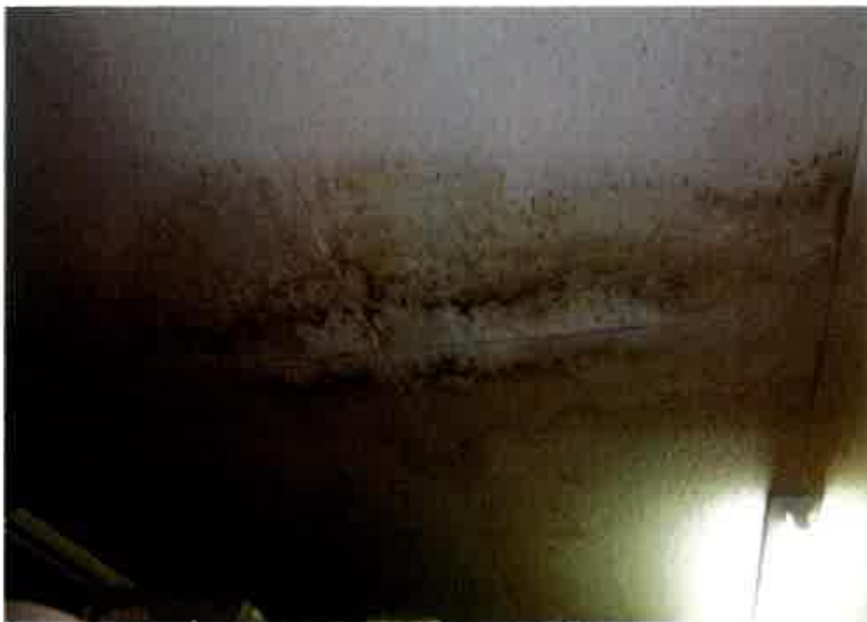
⑩屋内の状況 倉庫2の天井 の状況 (物件8)
