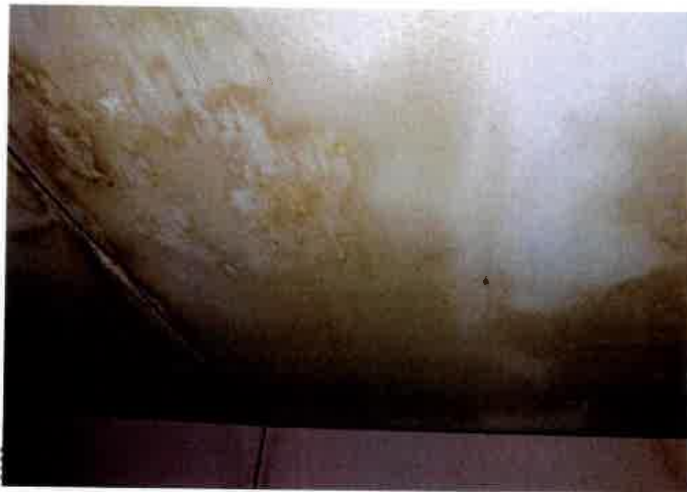
⑨屋外の状況 和室1の天井 の状況 (物件5) (主である 建物)
