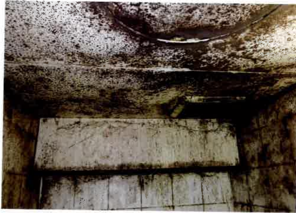
⑤屋内の状況 浴室の天井 の状況
