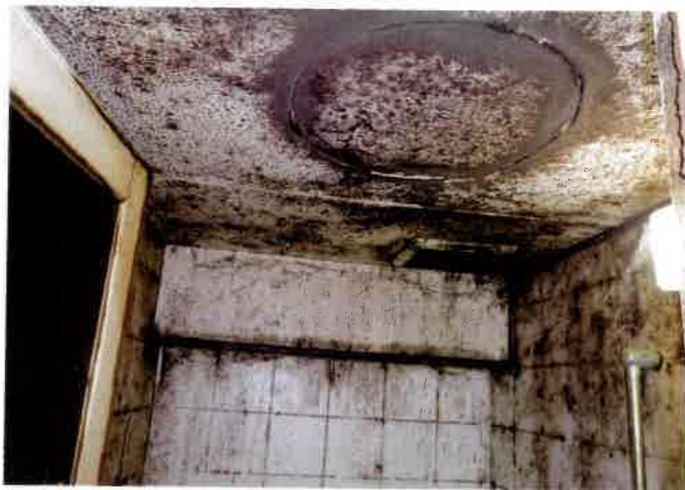
⑤ 屋内の状況 浴室の天井 の状況
