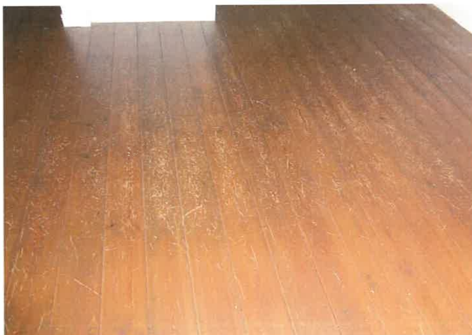
屋内の状況 LDK 床の損傷等
