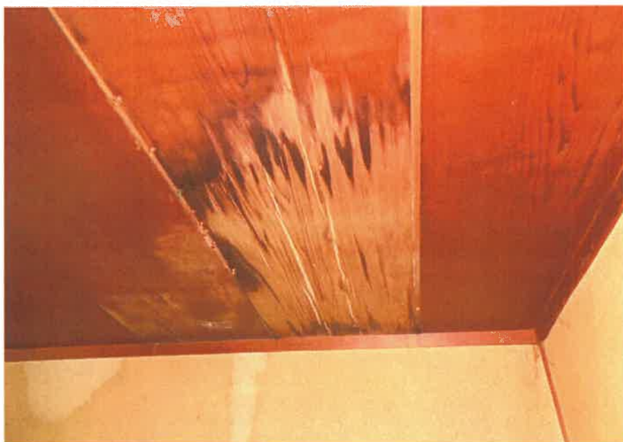
屋内の状況 和室2 天井の雨漏り跡
