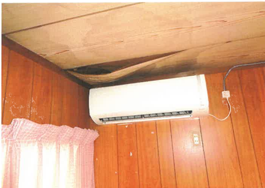
⑧ 屋内の状況 和室② 天井の雨漏り跡
