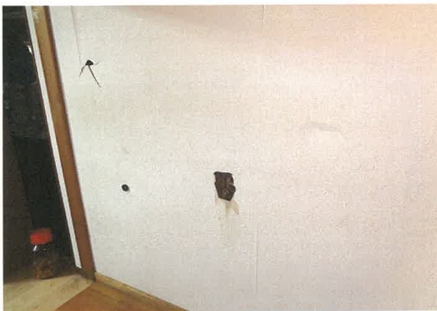
屋内の状況 居間 壁の破損等
