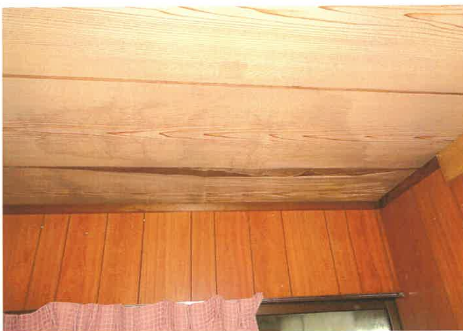
⑨ 屋内の状況 和室② 天井の雨漏り跡
