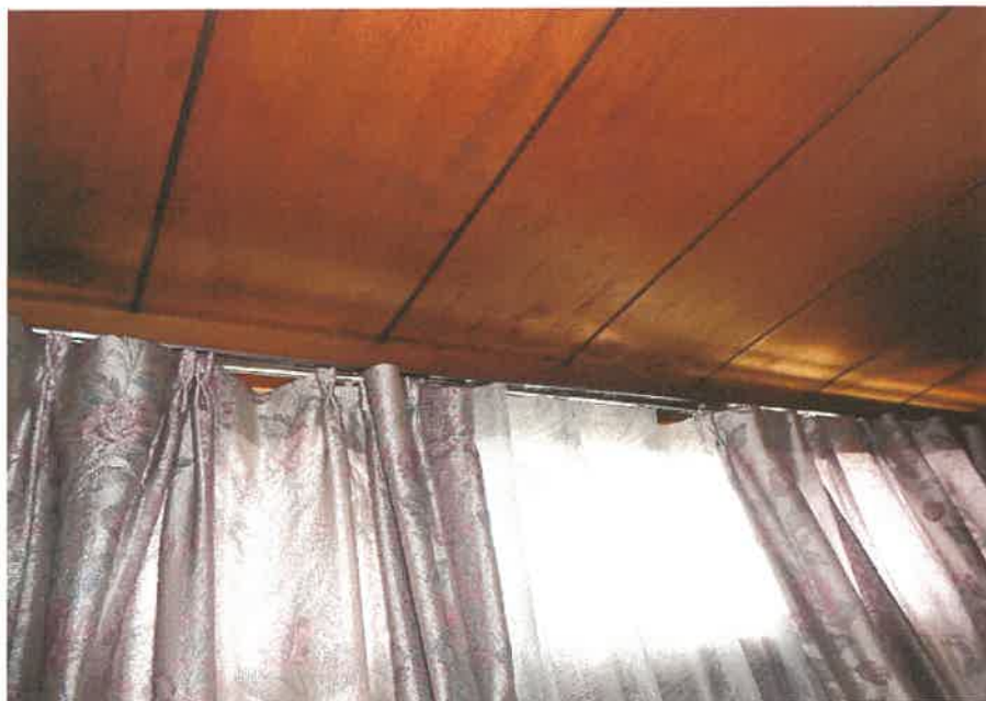
⑦ 屋内の状況 和室1 広縁 天井の雨漏り跡
