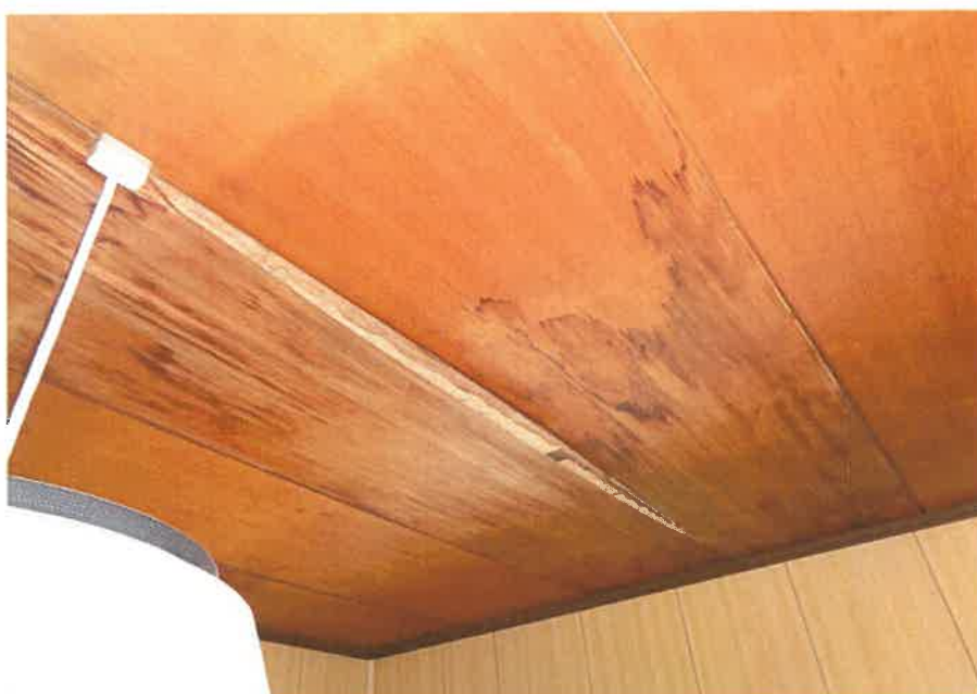
⑧ 屋内の状況 洋室4 天井の雨漏り跡
