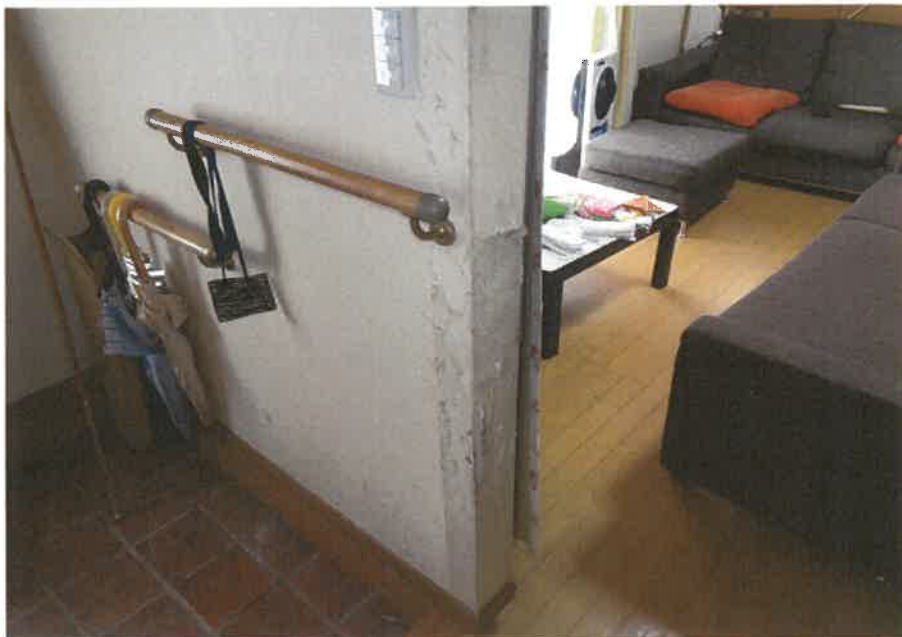
⑧ 屋内の状況 玄関 壁の損傷等
