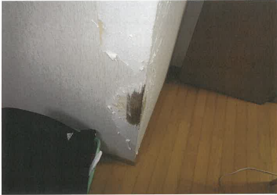
⑦ 屋内の状況 洋室1 壁の損傷等
