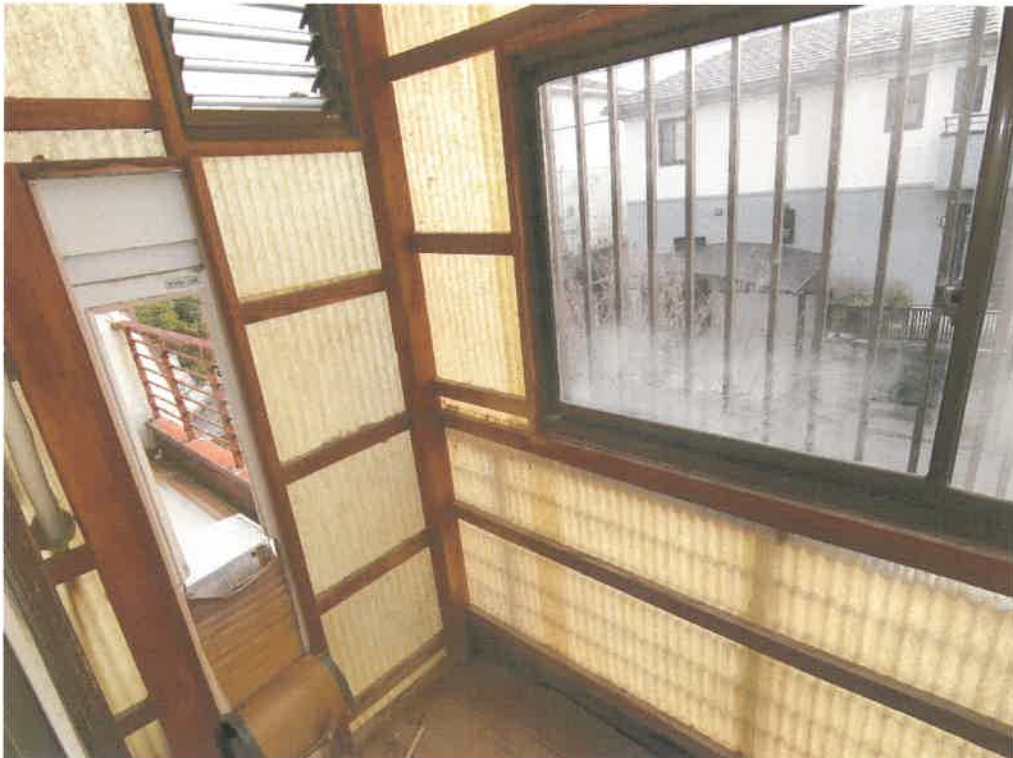
10 物件2内部の状況（壁面の損傷（洋室4南西側の増築部分））
