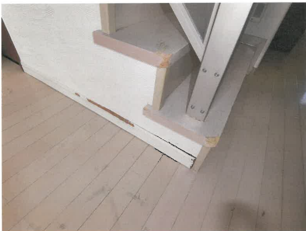
1 1 物件 2 内部の状況（巾木及び階段の損傷（1 階廊下））
