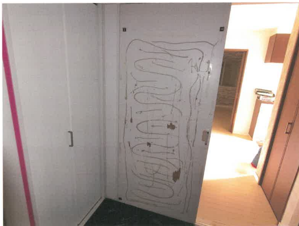
1 4 物件 2 内部の状況（引戸の汚損（洋室 1））
