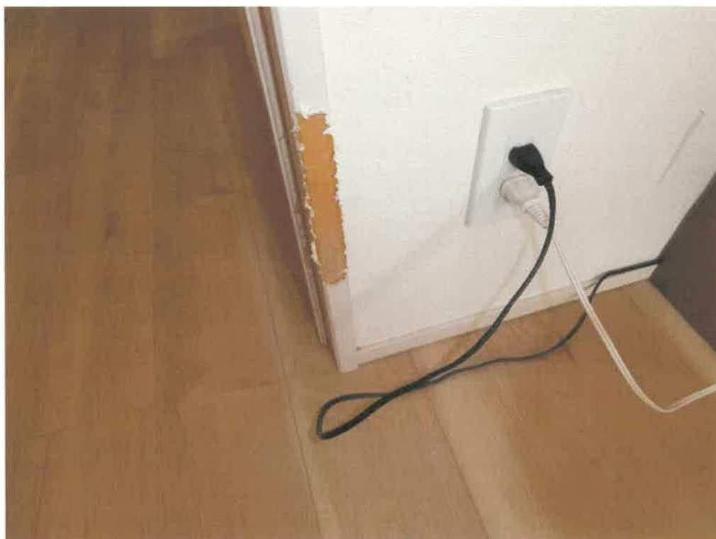
8 物件2内部の状況（建具の損傷（洋室①北側））
