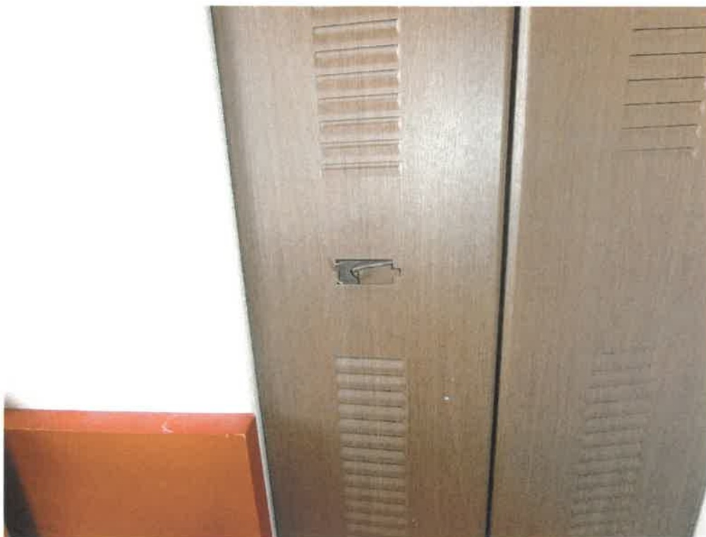
8 物件1建物内部の状況（C L（クローゼット））把手の欠損（洋室3））
