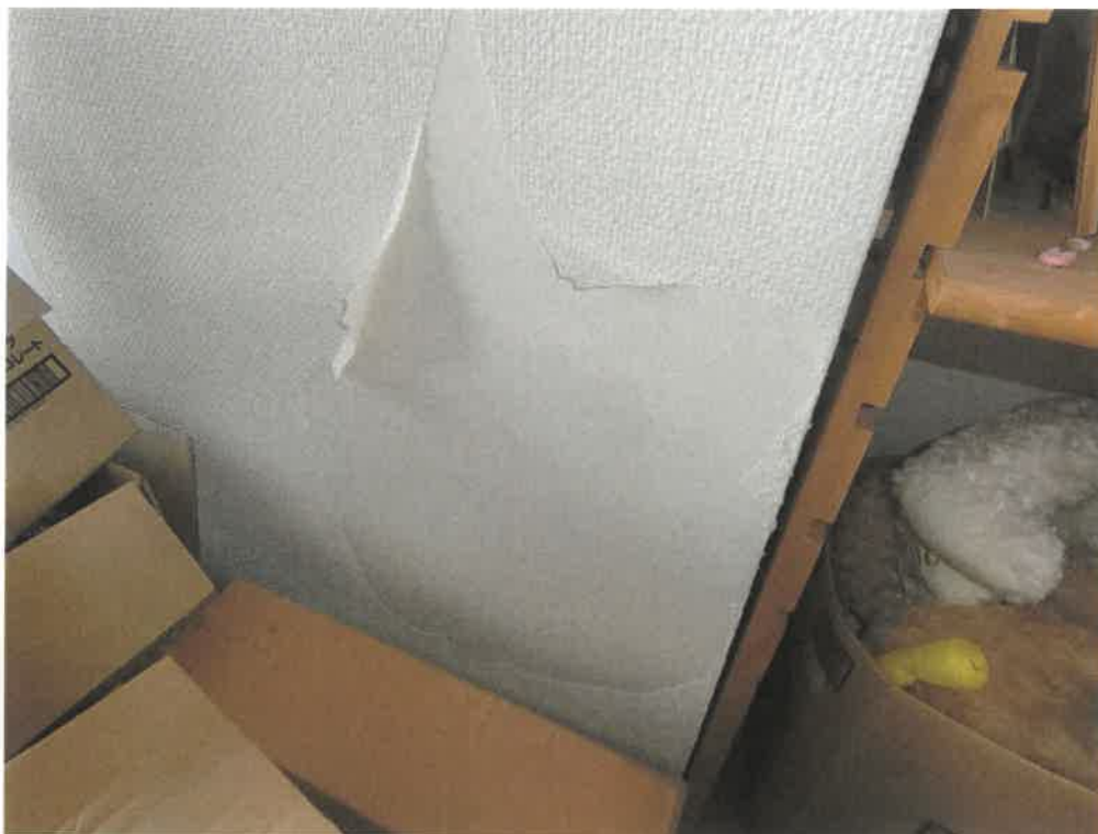
7 物件1建物内部の状況（クロスの剥がれ（洋室2））
