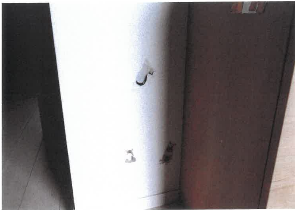
⑨ 屋内の状況（1階トイレ入口付近の壁に穴が開いている様子）
