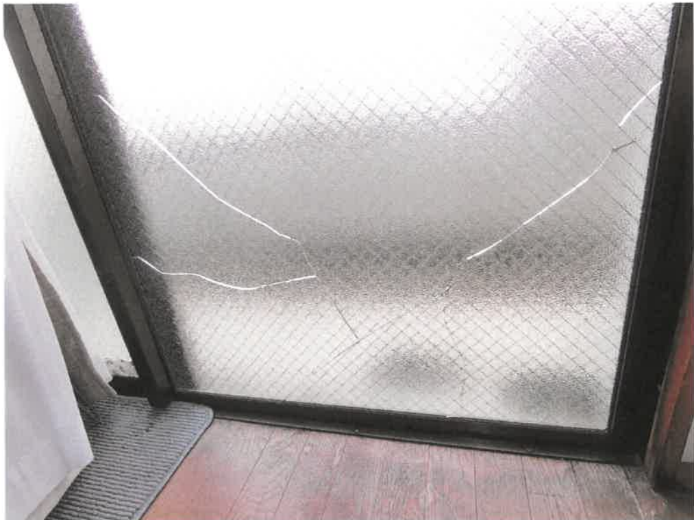
18 物件3建物内部の状況（S棟302号室・LDKの窓ガラス）
