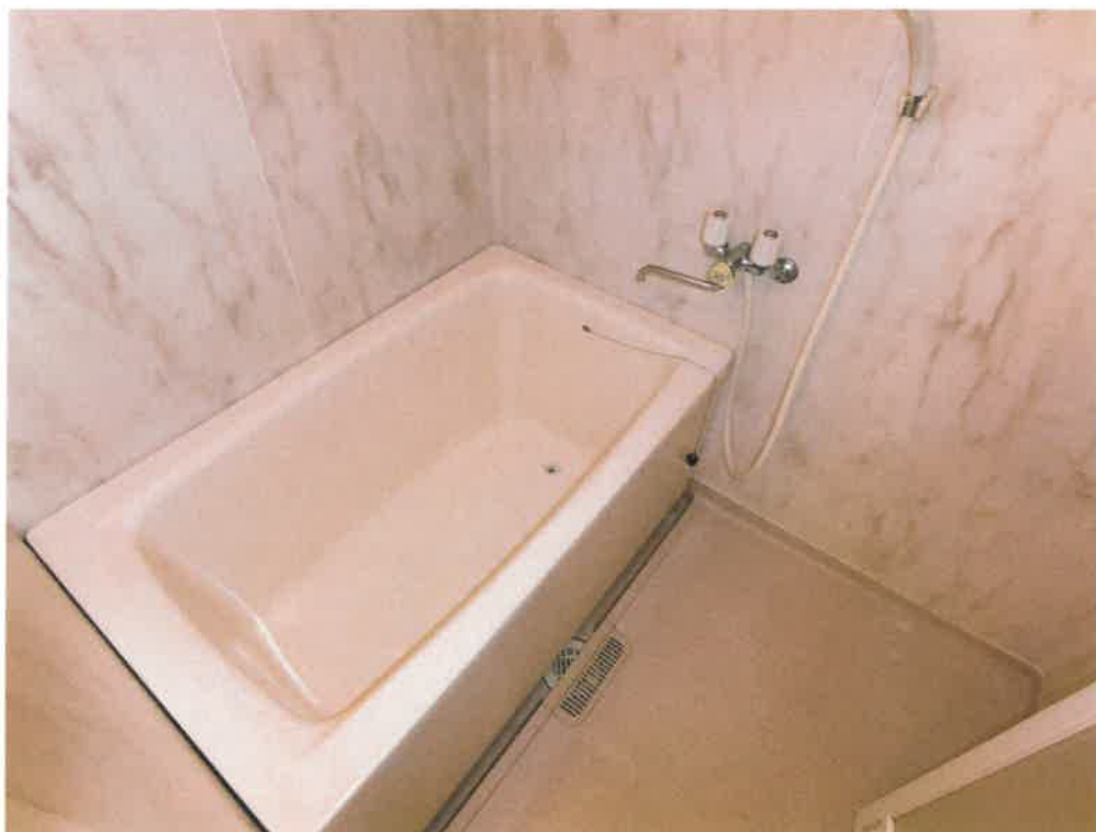
2 1 物件3建物内部の状況（S棟303号室・浴室）
