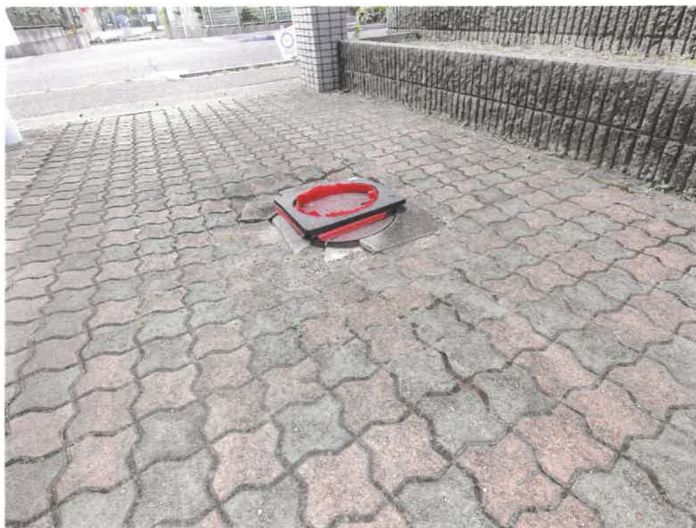
5 レンガ舗装の波打ち及び損傷（物件1 土地北部）
