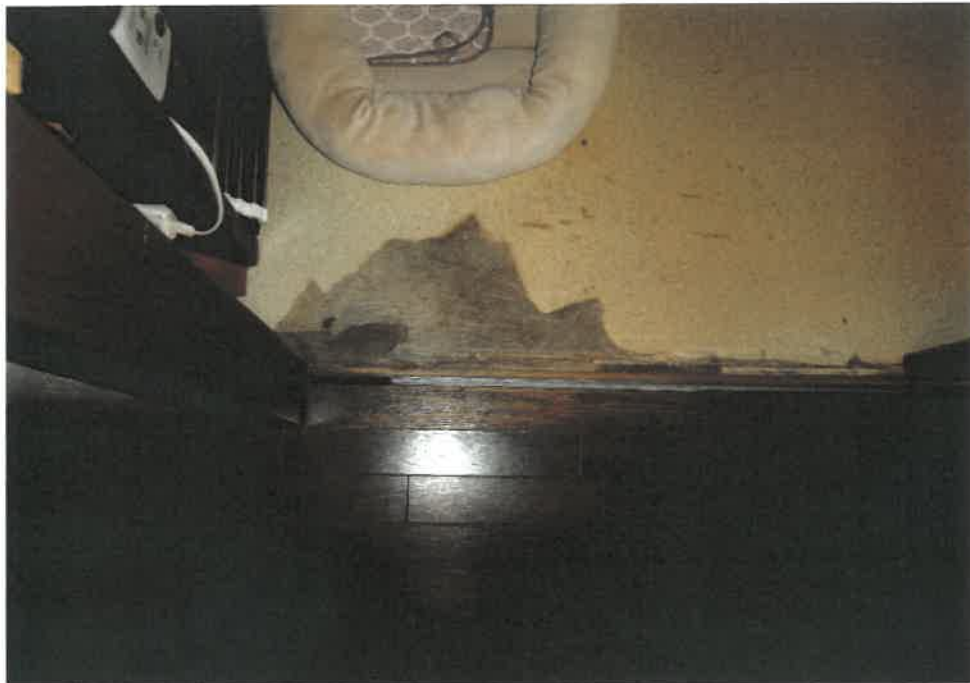
⑧ キッチン床が剥がれた状況
