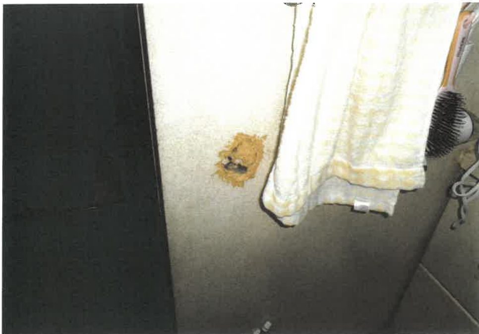
⑦ 洗面所内の壁の穴の状況
